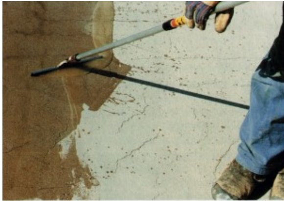
Kuva 5. Halkeaman imeyttäminen [1, s. 39].
