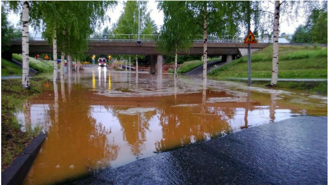
Kuva 6: Mustasuon alikulku tulvii Oulussa kesällä 2013. Vettä on tiellä noin metrin verran.
