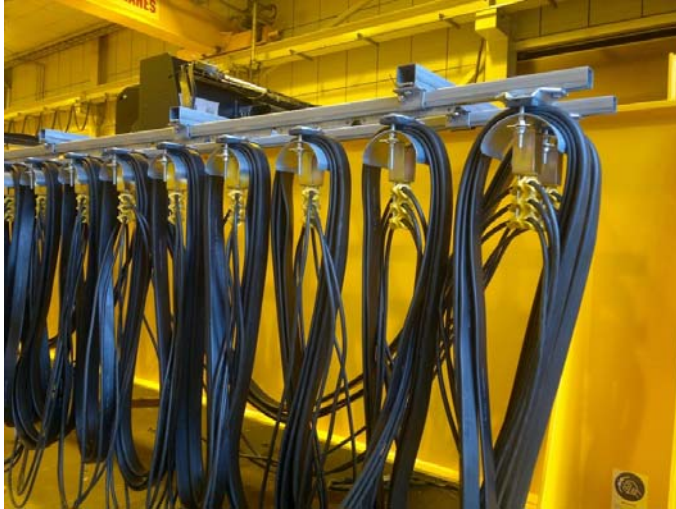
Kuva 2.11. Lattakaapeleilla toteutettu virransyöttö.
