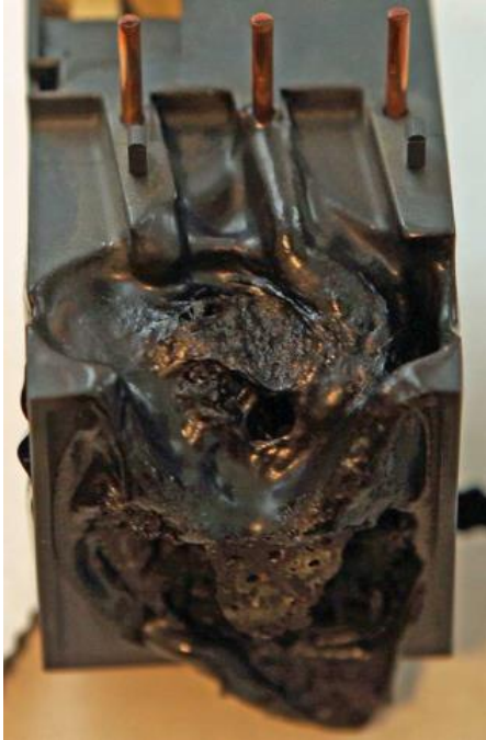
Kuva 33. Vaurioitunut kontaktori (© Jorma Korkalo, Primatest Oy).
