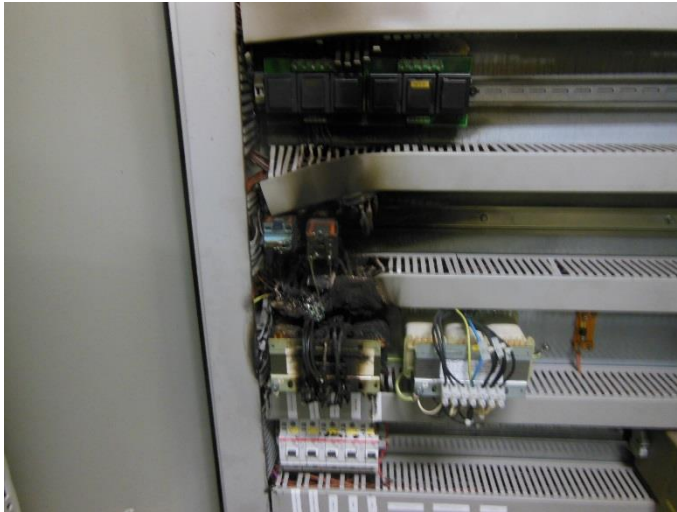
Kuva 40. Ukkosen aiheuttama ohjauskeskuksen vikaantuminen (© Ari Jurvanen, Keski- Suomen Pelastuslaitos).
