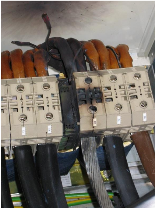
Kuva 23. Löystyneen liitoksen aiheuttaman lämmön nousun seuraukset (© Hannu Halminen, Bol-den Harjavalta Oy).
