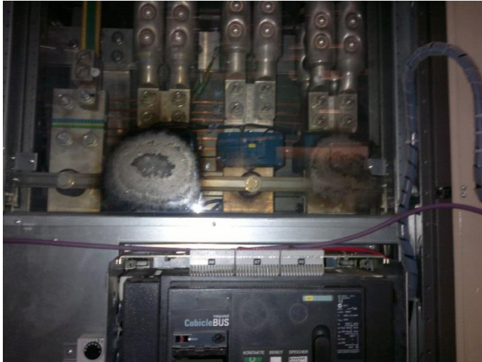
Kuva 29. Puutteellisen asennuksen aiheuttama oikosulku katkaisijan valokaaresta (© Juha Anttonen, Botnia Mill Service Oy).
