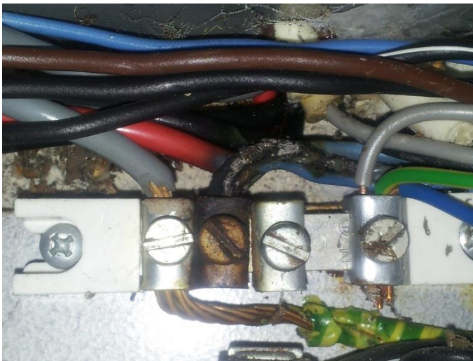
Kuva 22. Nollajohtimen liitoksen löystymisen aiheuttama vikaantuminen (© Marko Mäkeläinen, QM-Installation Oy).
