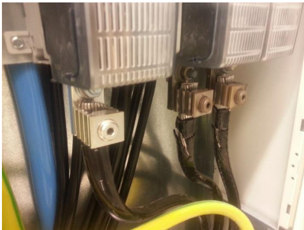
Kuva 20. Löystyneen liitoksen seurauksena sulaneet johdineristeet (© Pertti Kukkonen, Oy Elspecta Ab).
