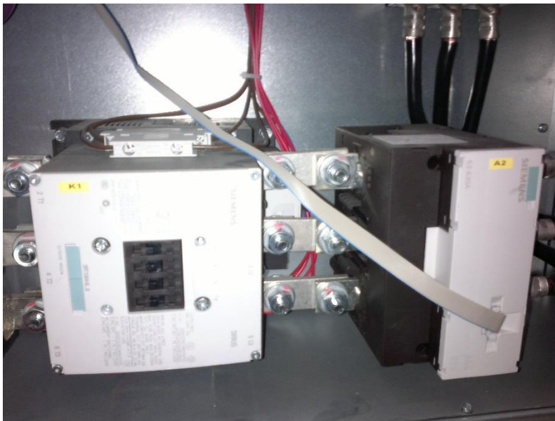
Kuva 32. Ohjausvirtapiirien väärä kaapelointireitti aiheuttaa pää- ja ohjausvirtapiirien välisen oikosulun riskin (© Juha Anttonen, Botnia Mill Service Oy).
