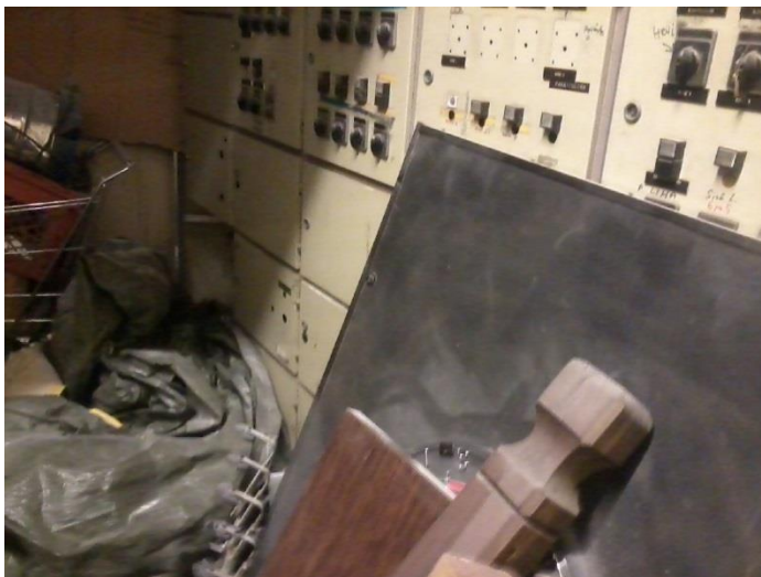
Kuva 37. Ylimääräinen tavara estää laitteistojen kunnossapidon ja lisää tilan palokuormaa huomattavasti (© Pertti Kukkonen, Oy Elspecta Ab).
