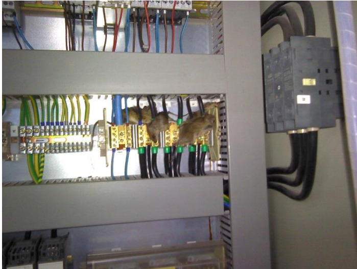
Kuva 34. Puutteellisten läpivientien vaikutus eläimien kulkeutumiseen jakokeskuksen jännitteisiin osiin (© If Turva-akatemia).
