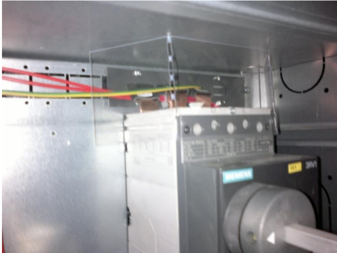
Kuva 31. Ohjausvirtapiirien väärä kaapelointireitti aiheuttaa pää- ja ohjausvirtapiirien välisen oikosulun riskin (© Juha Anttonen, Botnia Mill Service Oy).
