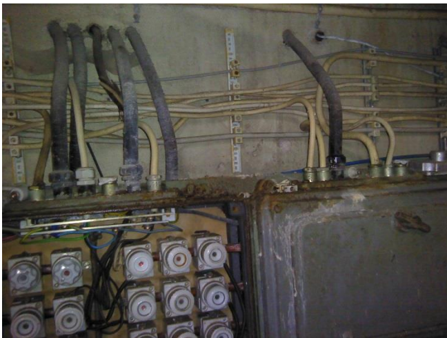
Kuva 24. Yläpuolen putkistoista vuotaneen veden ruostuttama jakokeskus (© If Turva-akatemia).
