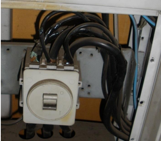
Kuva 21. Huonon liitoksen aiheuttama oksidoituminen ja eristemateriaalin sulaminen johtimessa (© Pertti Kukkonen, Oy Elspecta Ab).
