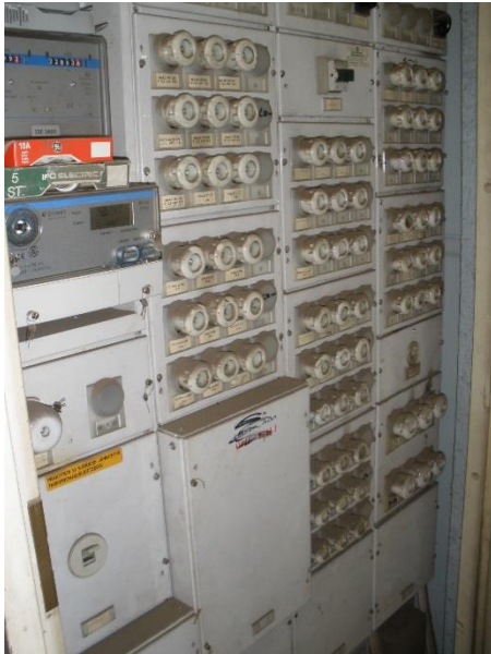
Kuva 39. Pölyä ja likaa on kertynyt runsaasti keskuksen ulkopinnoille (© Pertti Kukkonen, Oy Elspecta Ab).
