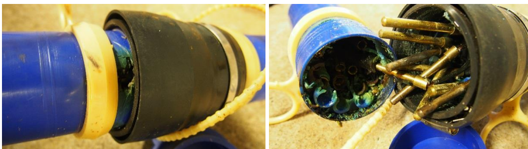
Kuva 26. Pistoliitimen kunto ennen avausta ja irtikytkennän jälkeen (© Sampsa Salmela, Napa-piirin Vesi Oy).
