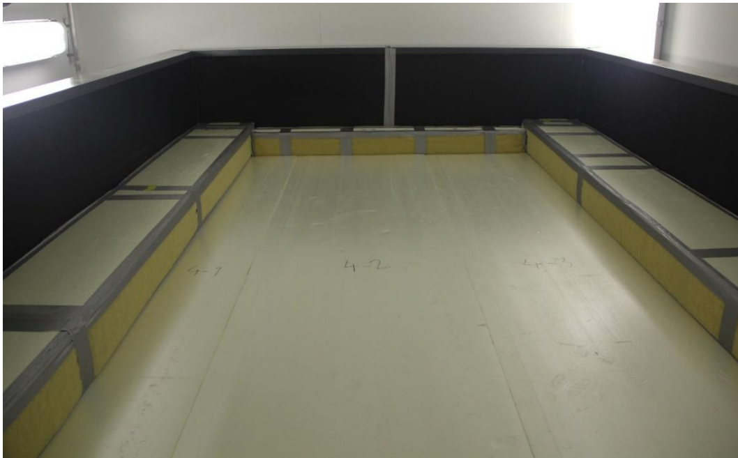
Kuva 3. Kalibrointikokeen valmistelu. Osa kalibrointieristeistä ja eristereunuksesta asetettuna laitteistoon.
