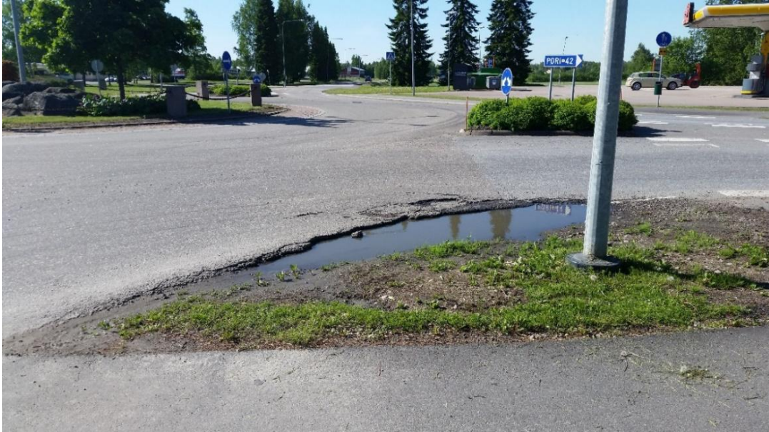
Kuva 21. Kulunut piennar pohjoisen ja lännen liittymähaarojen välissä Kauvatsantien kiertoliittymässä.
