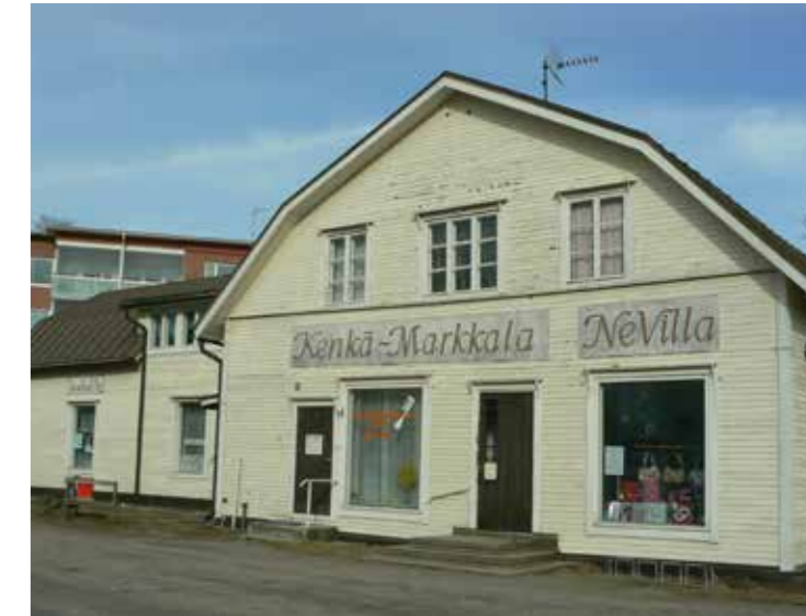
Markkalan julkisivulaudoituksen maalipinta hilseilee kauttaaltaan. Jo pelkän ulkonäön vuoksi rakennus tulisi maalata uudelleen.
