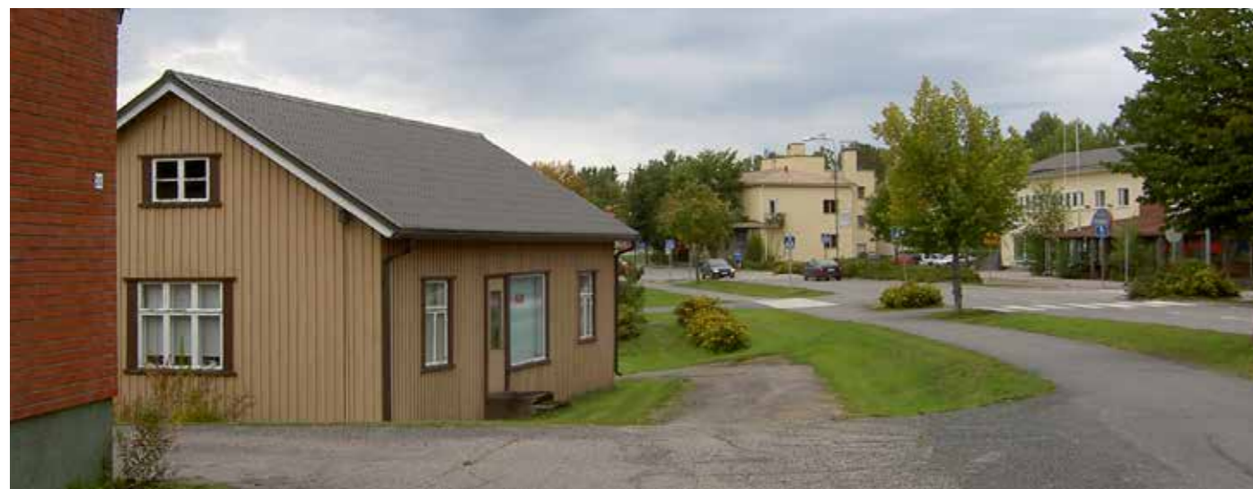
Entisen Mäen leipomon pihapiirin vanhin rakennus on huomattavan paljon jalkakäytävää ja ajotietä alempana. Kadunpuolen julkisivun sokkeli on kokonaan maan ja nurmen peitossa. Näyttää siltä, että kadulta laskevan rinteeseen vedet valuvat puurakennuksen sokkeliä vasten, mikä ei ole sen kunnossa pysymisen kannalta hyvä asia.
