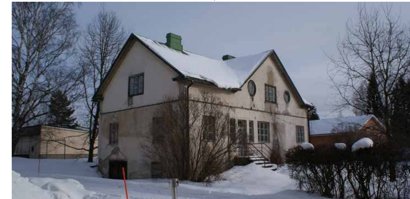
Suomelassa kaikki julkisivun osat ja katto ovat perusteellisen kunnostuksen tarpeessa.
