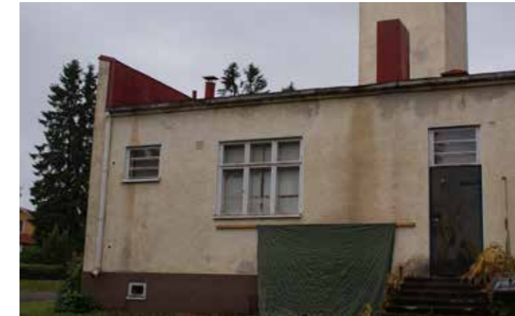
Vanhan paloaseman julkisivurappaus on laikukas ja huonokuntoinen.
