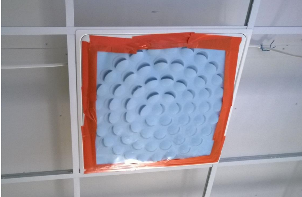
Kuva 3.18. Ilmanvaihdon suutinhajottajan pölysuojaus tutkimuskohteessa, jossa vaatimuksena on rakennustöiden ja ilmanvaihtojärjestelmän P1-puhtausluokka.
