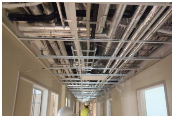
Kuva 46. Sairaalarakennuksen alaslaskukattoon ahdettua talotekniikkaa.
