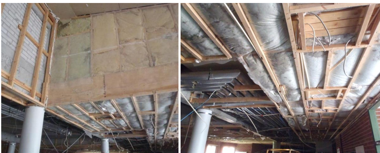
Kuva 42. Yläpohjan höyrinsulku sisälsi useita epätiivelyskohtia. Talotekniikka aiheutti lisähaasteita alakattorakenteiden toteutukselle.
