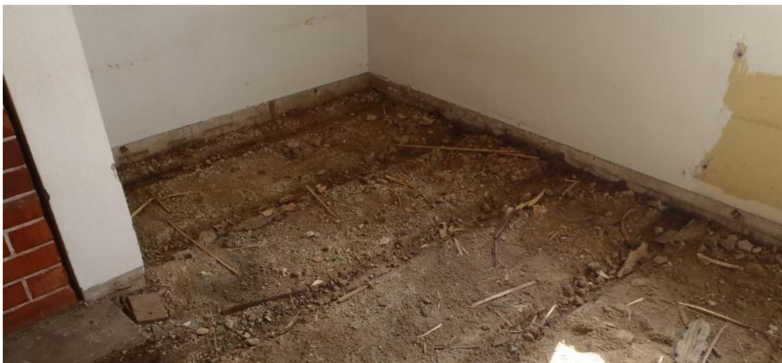
Kuva 38. Alapohjarakenteessa paljastui purettaessa puusilppua sisältävä hiekkakerros. Korjaussuunnittelija oli pyydetty selvittämään mitä rakenteelle tehdään. Havainto ilmeisesti laajensi rakenteen aiottua purku- ja korjaustarvetta. Aiemmin tehdyssä kuntoarviossa oli esitetty, että alapohjaan ei liity korjaustarvetta.
