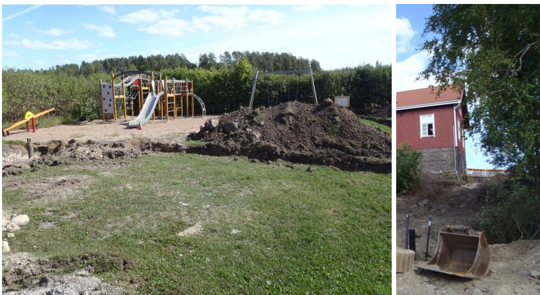
Kuva 36. Molempien koulujen lämmitysjärjestelmä muutettiin maalämpöön. Hankkeen toteutukseen oli saatu ns. EU-rahoitusta ympäristöystävällisyyden parantamiseksi. Kesällä kaivutyöt olivat leikkikentän esteenä.
