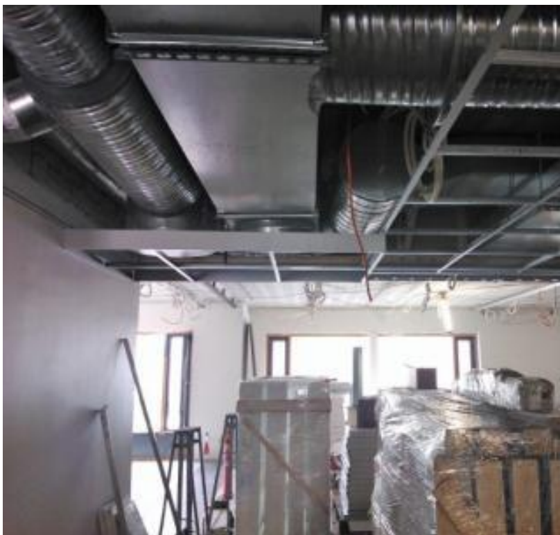
Kuva 27. LVI- ja sähköurakoiden aikataulutuksen yhteensovittamisessa oli ollut ongelmia ja huonekorkeutta oli täytynyt paikallisesti madaltaa. (Aulatilaa käytettiin rakennusmateriaalien varastointiin.)
