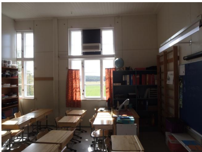
Kuva 35. Kyläkoulun toinen rakennus korjattiin ensin, joten jatkuvan toiminnan ylläpitämiseksi toisen rakennuksen luokkia oli jouduttu jakamaan tehokkaampaan käyttöön. Peruskorjausta odottavan rakennuksen sisäilmaa oli pyritty parantamaan tilakohtaisilla laitteilla.
