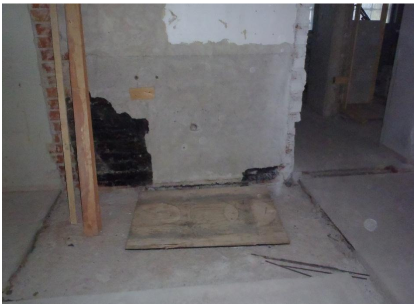
Kuva 31. Purkuvaiheessa ilmeni ohuita rakennekerroksia, joita ei ollut havaittu kuntotutkimuksessa. Materiaalit selvitettiin ennen purkutöiden jatkamista.
