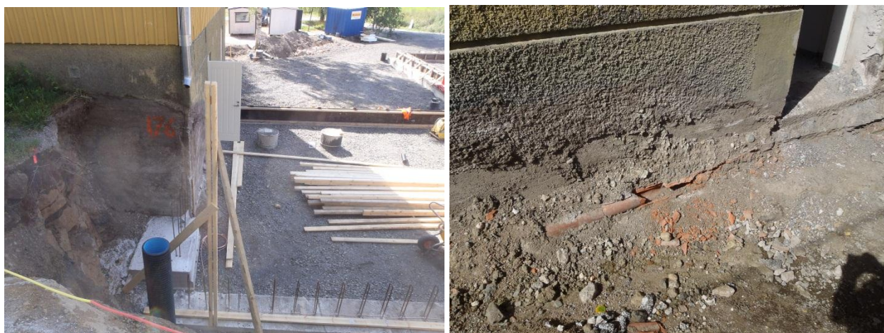
Kuva 40. Laajennusta pystytettäessä vanhan rakennuksen sadevesiä ei ollut johdettu pois. Salaojat oli tarkoitus uusia. Vanhojen tiilisalaojien huono kunto ja riittämätön asennussyvyys oli tiedossa, vaikka kuntoarviossa ei ollut mainintaa asiasta (kuntoarviossa todettiin ettei sokkelissa havaittu merkittäviä vauriokohtia).
