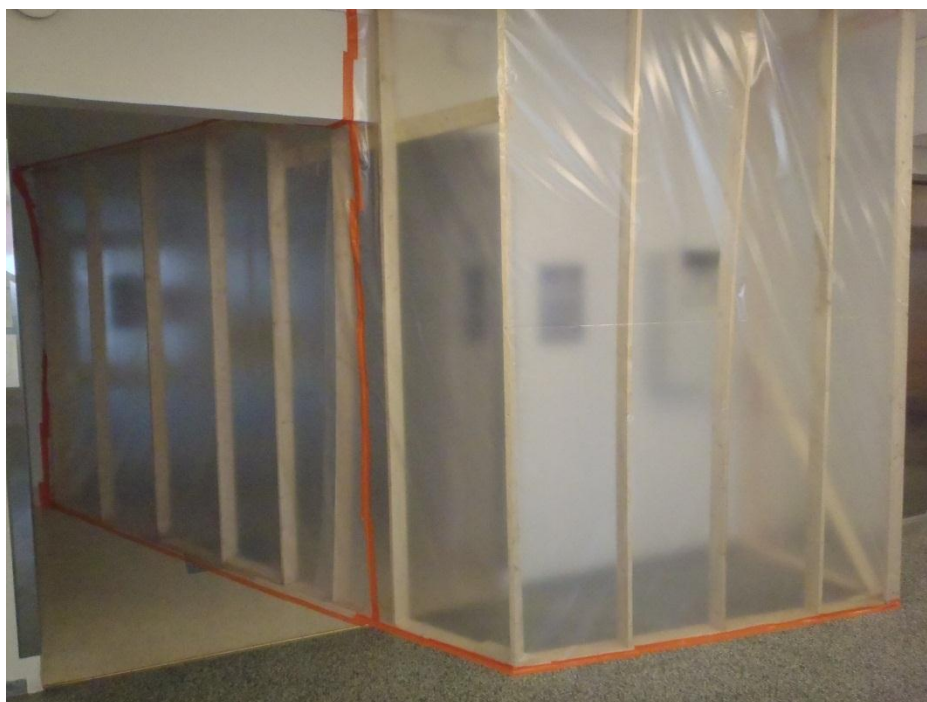
Kuva 29. Pölynsuojaus, josta kuitenkin puuttui suunniteltu kulkuyhteys.
