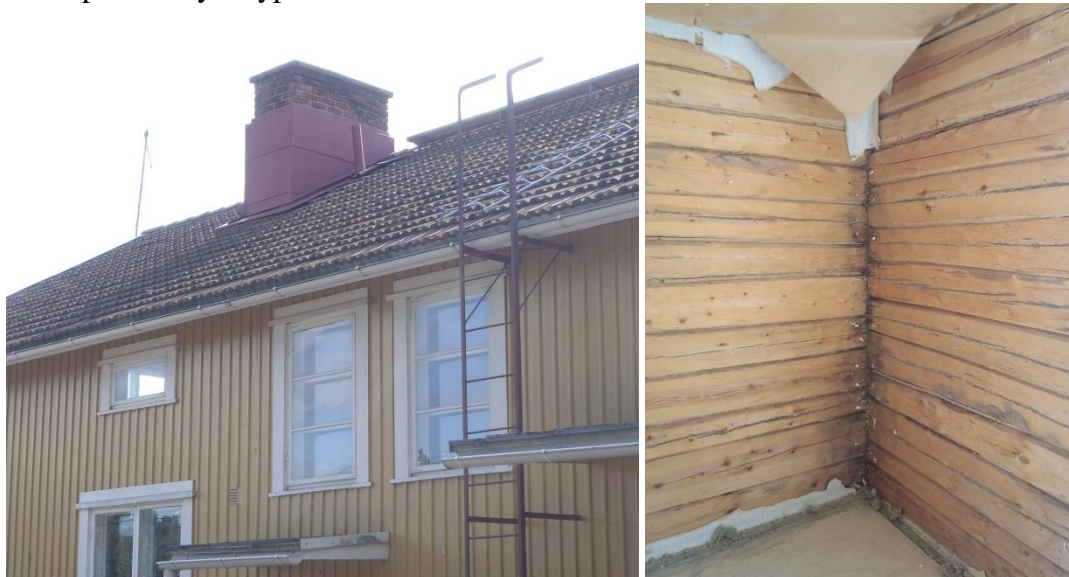
Kuva 39. Kuvassa vasemmalla alakoulun vesikatto ja julkisivu. Kuvassa oikealla tummuneita hirsii rakennuksen nurkassa.
