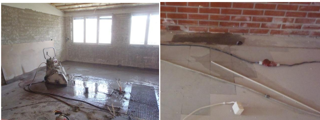
Kuva 41. Laajennettavan keittiötilan vanhan betonilaatan poisleikkaukseen tarvittun vesiletkun liitos oli hieman vuotanut viereisen tilan lattialle. Korjaussuunnittelija sekä valvoja puuttuivat asiaan sen havaittuaan.
