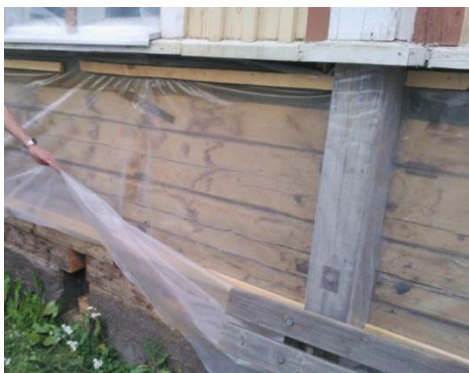
Kuva 34 Seinän alaosan lautaverhous oli poistettu, jotta alimpien hirsien kunto voitiin tarkastaa ja tarvittaessa uusita. Muovikalvo toimi työnaikaisena suojauksena. Alkuperäinen tai sitä vastaava verhous oli tarkoitus palauttaa.
