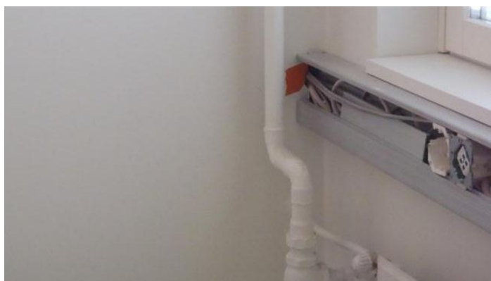
Kuva 43. Lähes valmiin sisätyövaiheen jälkeisissä mittauksissa havaitut epätiiviyshkohdat oli merkitty oranssilla teipillä.
