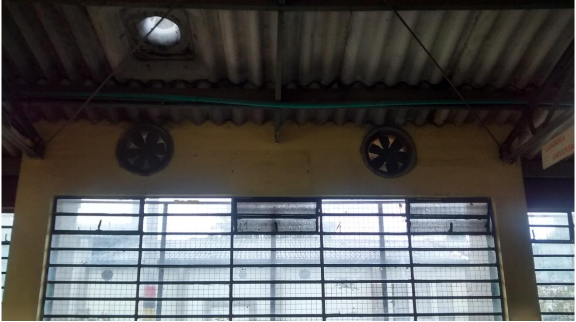
Anexo 6. Extractores en el taller de ebanistería
