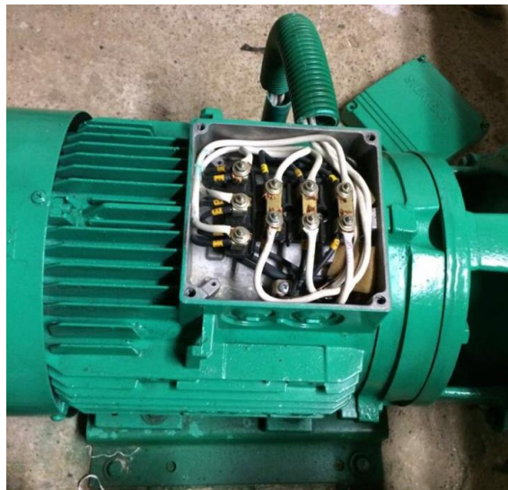
Figura 11. Bornera ((Propiedad de los autores Ingecol S.A.S), 2018)
