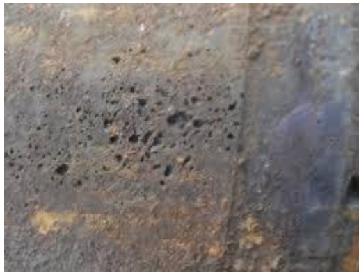
Ilustración 10. Corrosión por altas temperaturas
