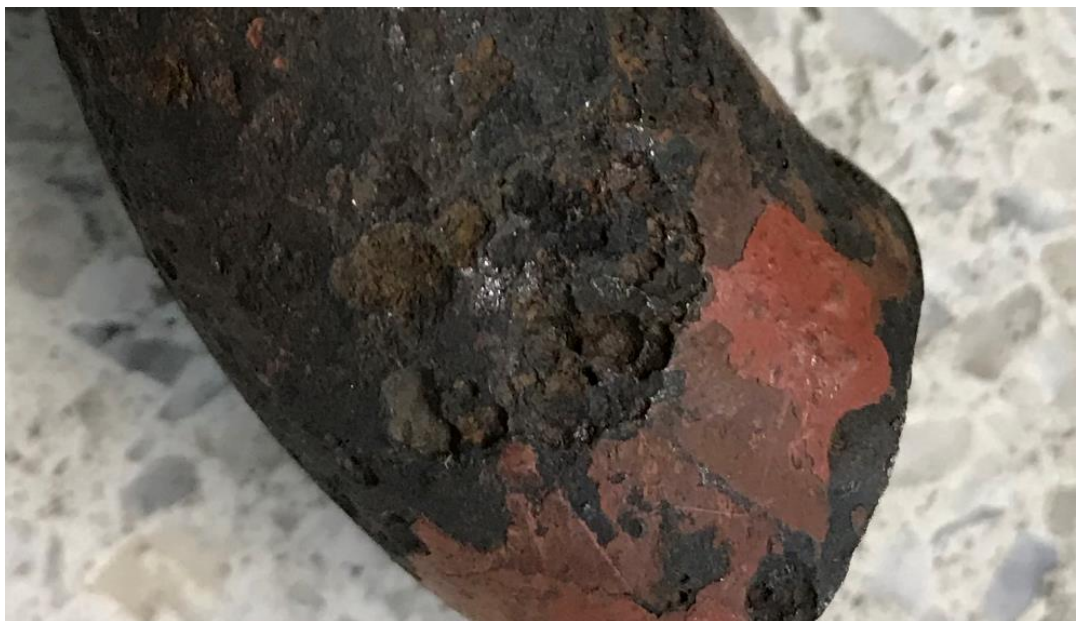
Ilustración 16. Detalle del punto de falla de la tubería.
