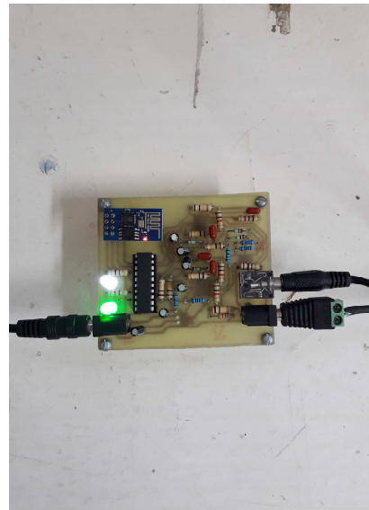
Figura 2-67. Montaje de medidor energético IoT a la alimentación del aire acondicionado (Toma B).
