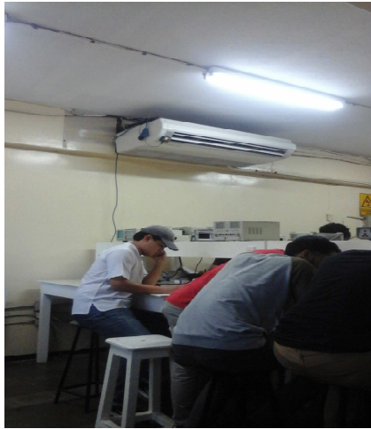
Figura 2-70. Montaje del controlador inteligente en el aire acondicionado del laboratorio de circuitos de FEC-UNI (Vista A). Fuente: Autor.
