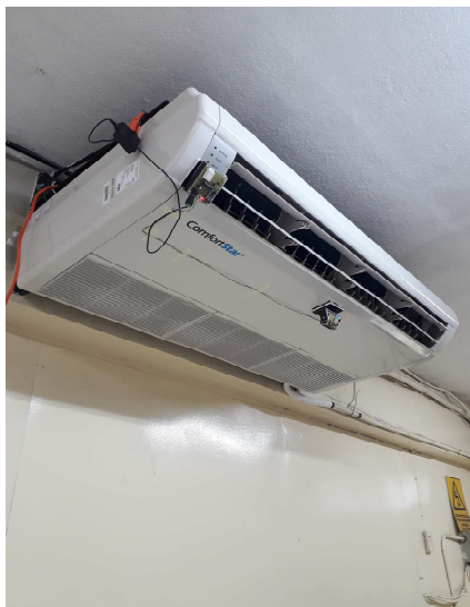
Figura 2-72. Montaje del controlador inteligente en el aire acondicionado del laboratorio de circuitos de FEC-UNI. (Vista C). Fuente: Autor.
