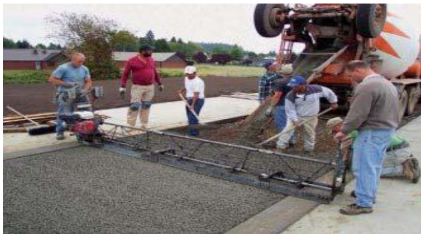
Figura 2. 17 Colocación del concreto permeable por medio de un camión mezclador con descarga por atrás
