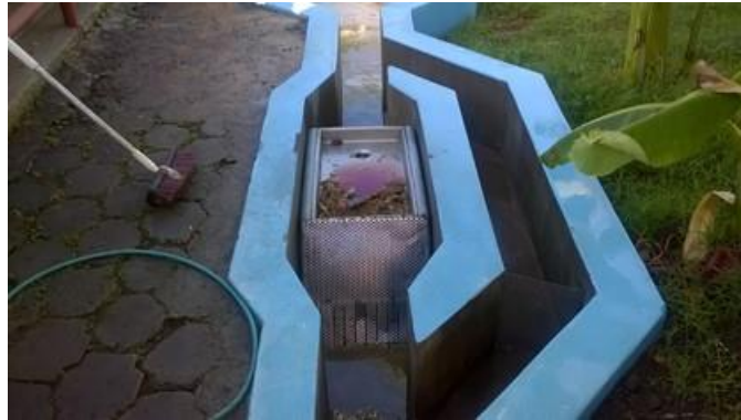
Imagen 2.- Canal de Entrada con Rejas
