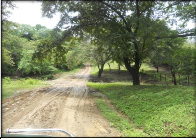
Panorámica llegando a vado de Est. 6+580, viendo hacia San Rafael del Sur
