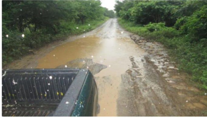
Formación de baches por situación anómala en la vía sin drenajes laterales
