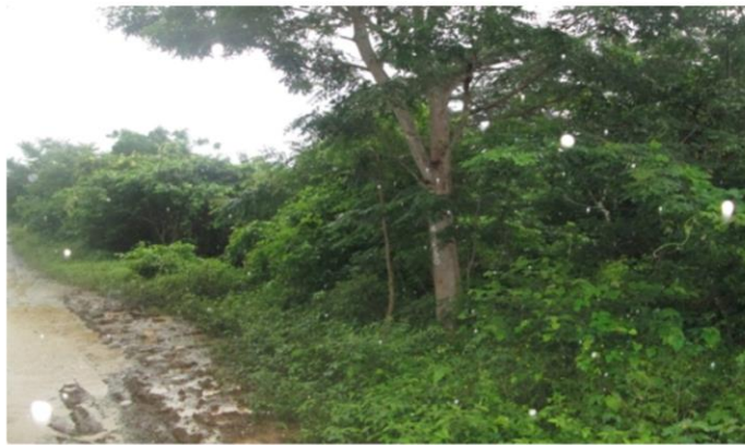
Est. 9+100, situación actual de la vía, faltan cunetas y/o alcantarillas
