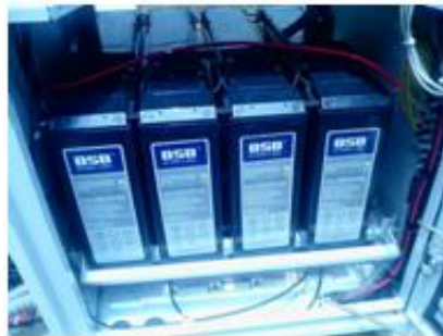
Figura 1- 7 Arreglo de baterías de 4 unidades en gabinetes de macro celdas.
