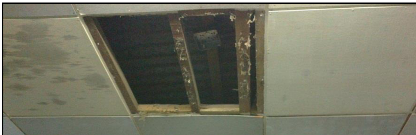
Imagen 29. Cielo falso en mal estado en el CSGGL. Fuente: Propia.
