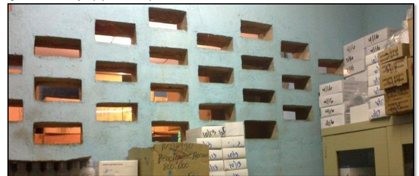
Imagen 25: Pared con ladrillos para el flujo de aire acondicionado en el Despacho de Medicina del CSGGL. Fuente: Propia.
