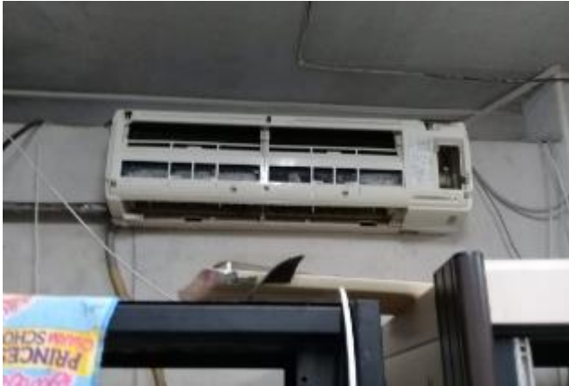
Imagen1 Aire acondicionado en mal estado lo cual provoca temperatura no estable al rack del area de cobros y actualización de dominios
