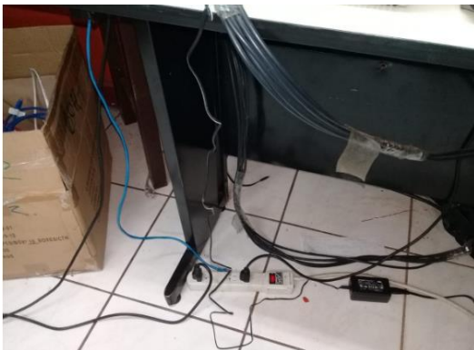
Imagen7 Demasiados errores de interconexión.
