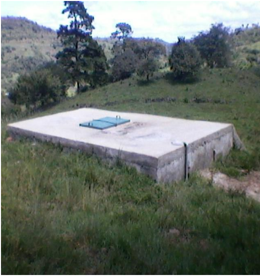
Figura 59. Pila de agua
