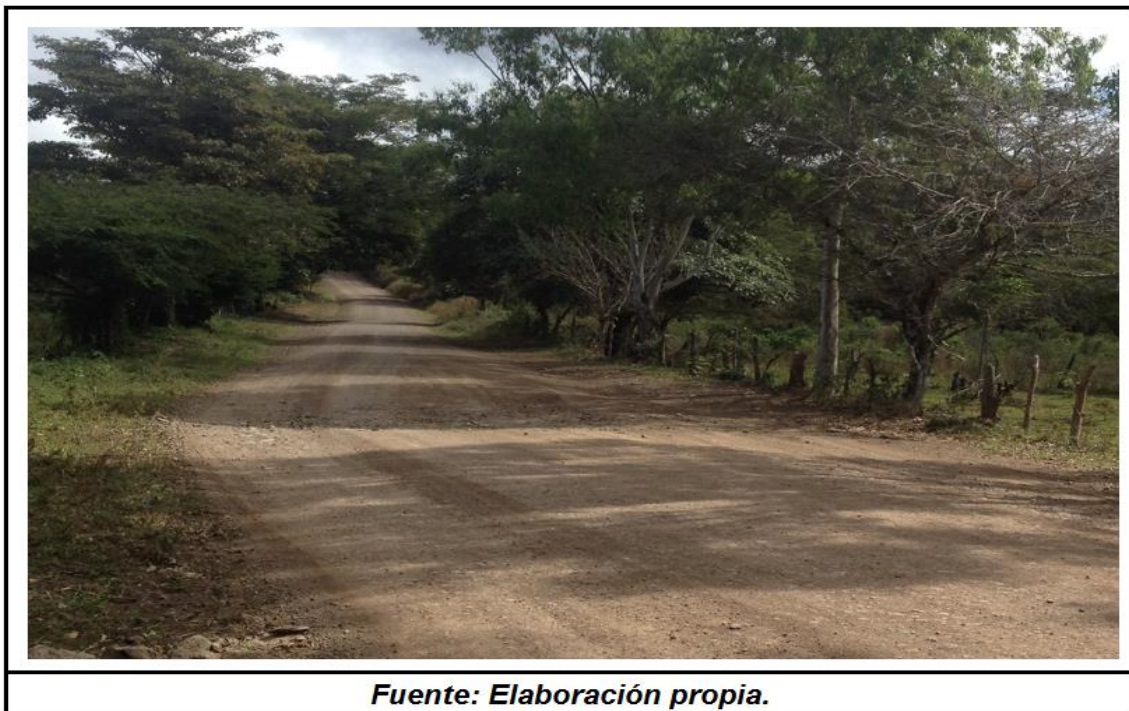
Ilustración No. 5. Formación de cárcavas sobre la vía.
