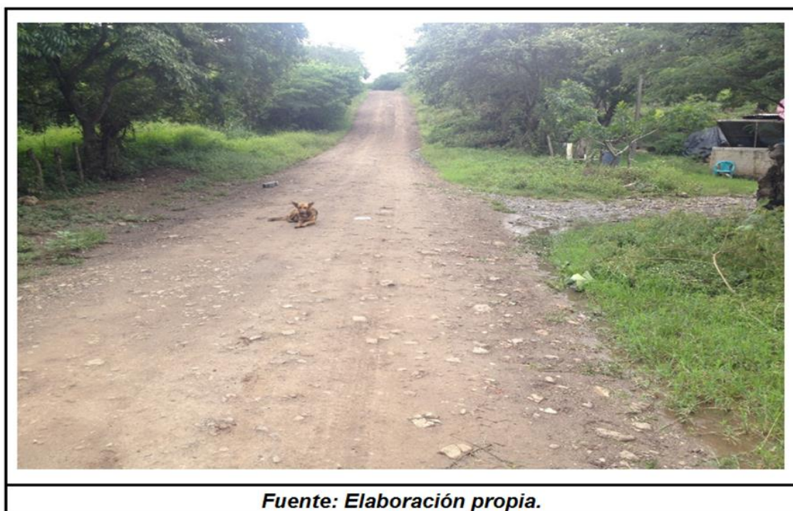
Ilustración No 6. Erosión del material de la vía debido a las lluvias y tránsito.
