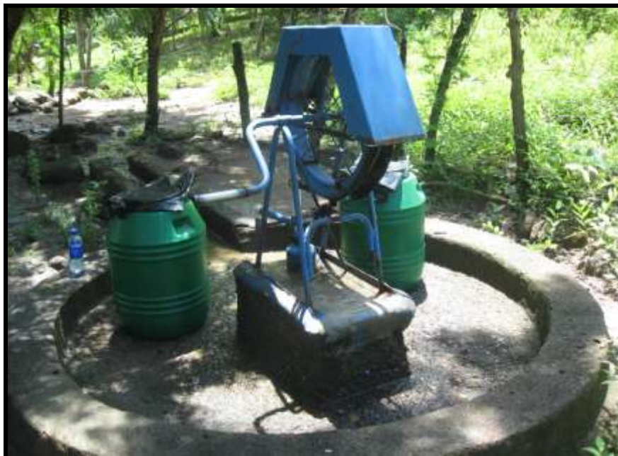
Foto 1 Pozo perforado equipado con bomba de mecate, situado en la comunidad de Linda Vista municipio de Santa Rosa del Peñón
