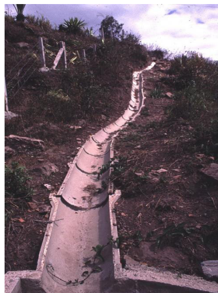
Ilustración 31 Contracuneta en funcionamiento
