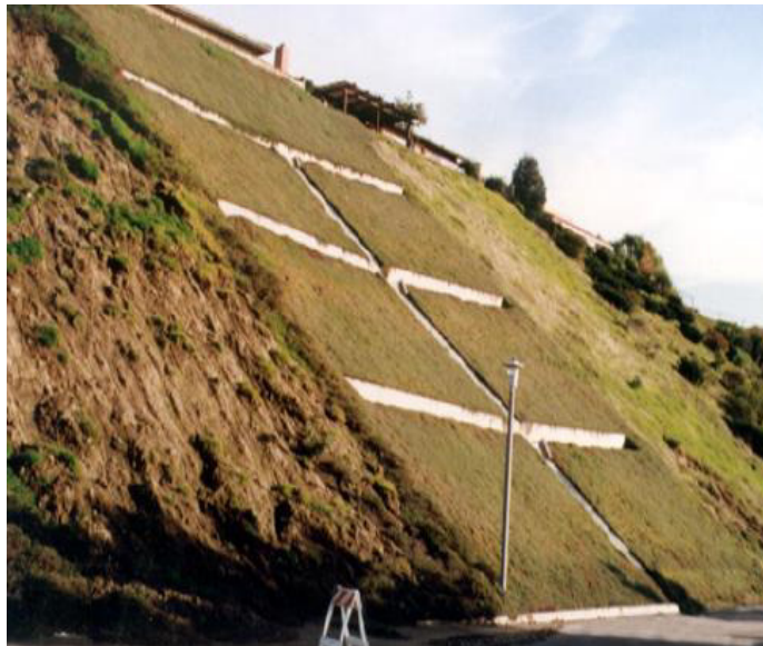
Ilustración 33 Canales interceptores en talud
