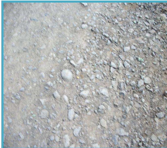
Condición del terreno en un tramo de la vía
