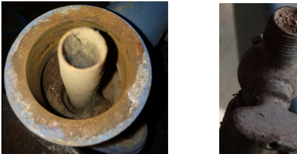
Figura 16. Tubería y válvula de paso obstruidas.
