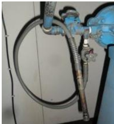
Figura 23 Mechero en el sistema de tuberías del horno de temple.
