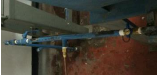
Figura 22 Bypass en la tubería de gas.
