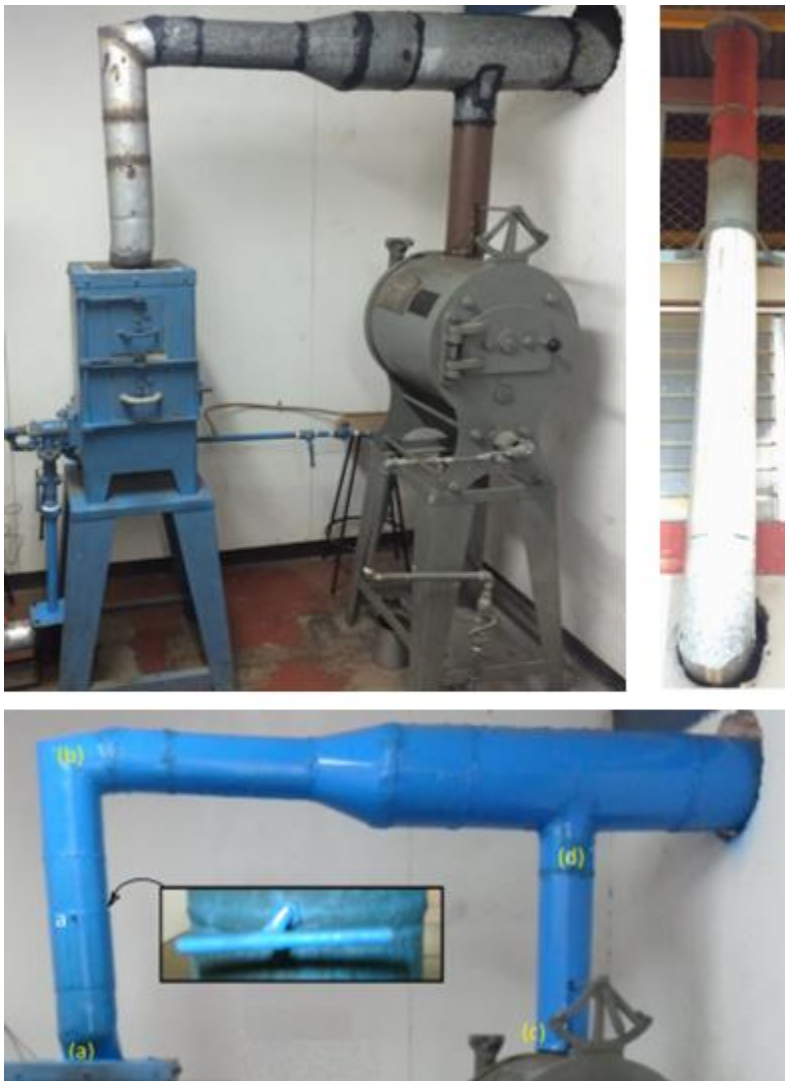
Figura 25. Tubería de evacuación de gases.
