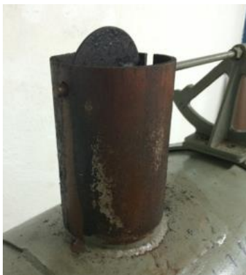
Figura 9. Válvula de Mariposa en la salida del Horno de revenido.
