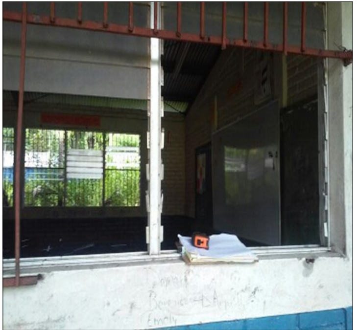
Falta de persianas/Fuente:Elaboración propia
