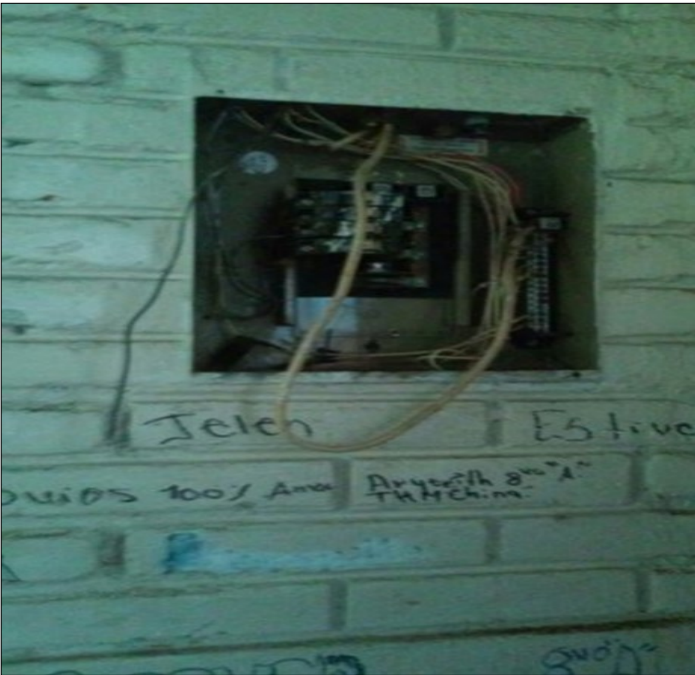
Eléctricidad deficiente / Fuente:Elaboración propia.
