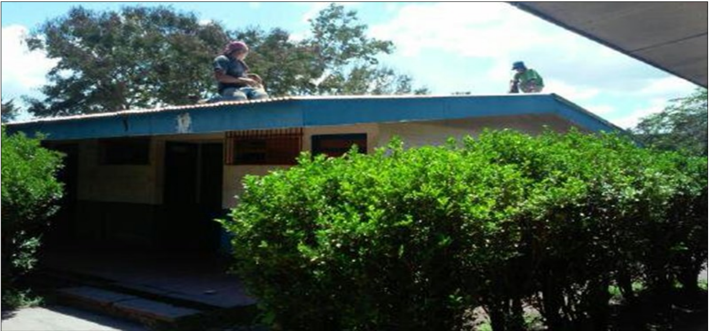
Eléctricidad deficiente / Fuente:Elaboración propia.
