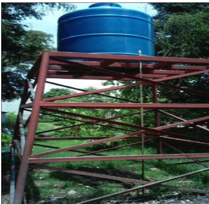
Tanque de Agua / Fuente:Elaboración propia.
