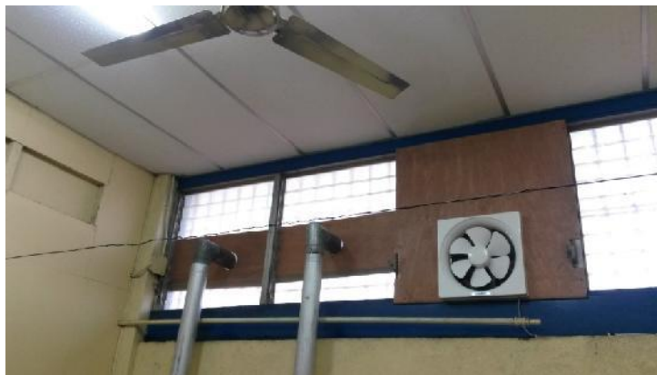
Foto 1 – sistema de ventilación del ambiente de pruebas.
