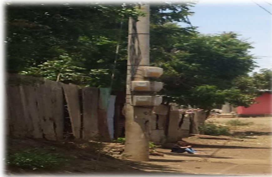
Imagen No. 79. Poste Eléctrico, a 50 metros del terreno.
