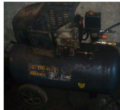
Imagen 23: Compresor de aire
