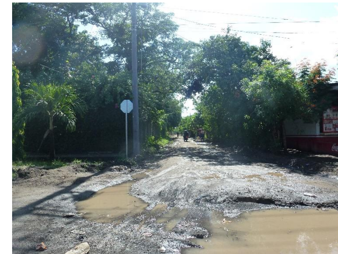
Imagen 27: Camino en mal estado Bo Marvin Salazar
