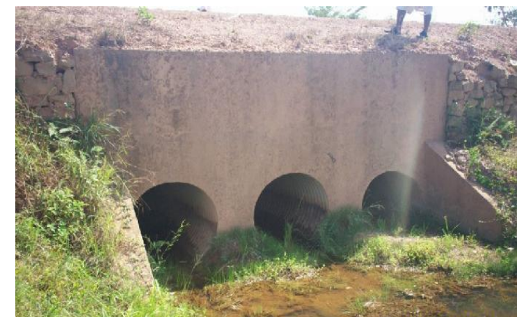
Daño de estanque amiento en el sistema pluvial
