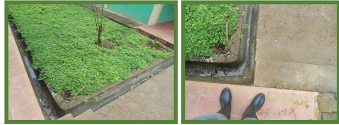
Ilustración 97: Vista de cunetas que distribuyen las aguas pluviales.
