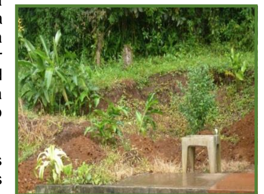
Ilustración 63: Presencia de erosión producto de la ausencia de arbustos y cubierta vegetal.
