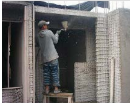
Figura No.1.21. Proceso de revoque de capa inferior losas estructurales paneles EMMEDUE.
