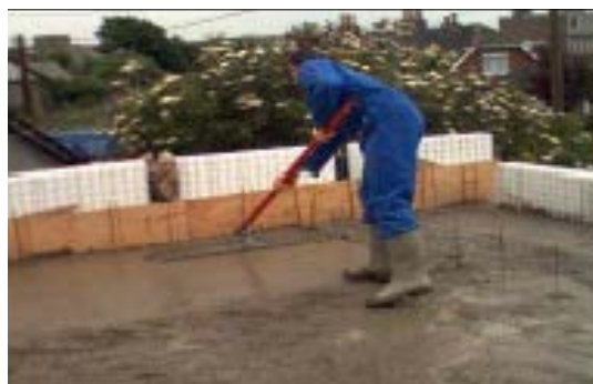
Figura No.1.20. Proceso de colado de capa superior losas estructurales paneles EMMEDUE.
