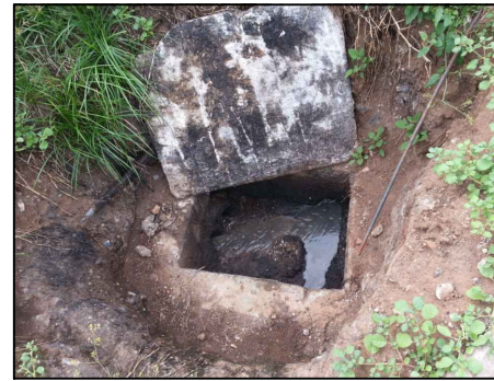
1- Caja de registro 0.55 x 0.70m.
