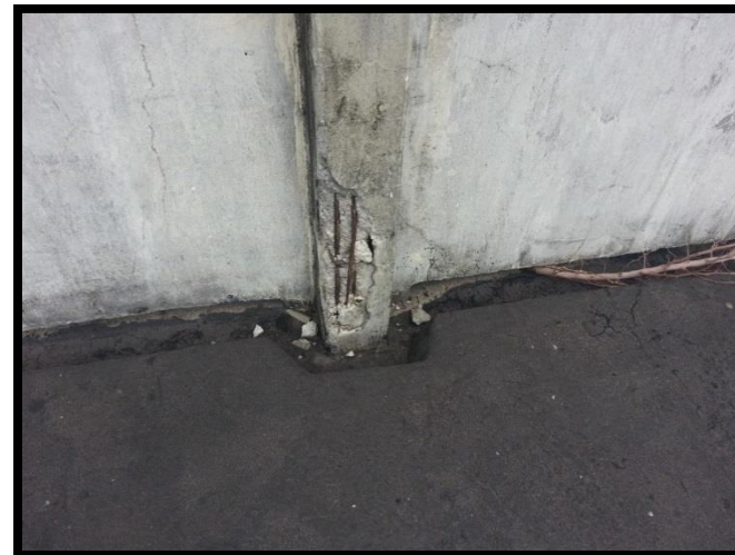
Figura 59 Oxidación en armadura de columna por exposición a la intemperie azotea fachada este. Recuperado de Archivos Fotográficos Propios, 2015.
