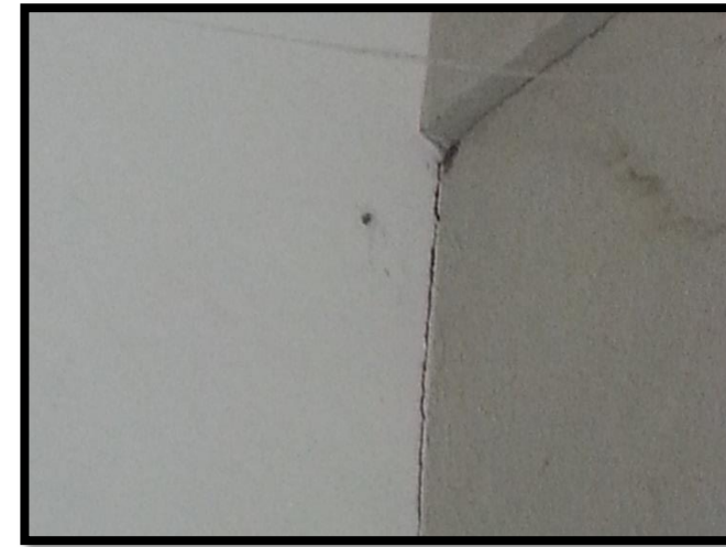
Figura 96: Grieta por discontinuidad constructiva en el taller de bobinado del segundo nivel. Recuperado de Archivos Fotográficos Propios, 2015.
