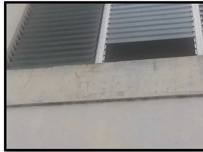
Figura 52 Fisuras inherente al acabado en fachada este. Recuperado de Archivos Fotográficos Propios, 2015.
