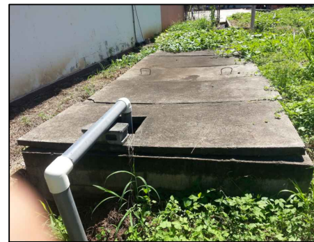
4 - Pila de drenaje con sistema FAFA 2.65 x 9.90m.
