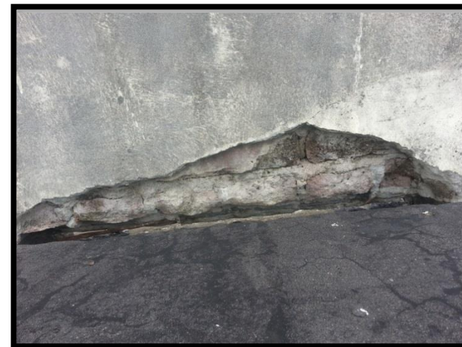
Figura 55 Desprendimiento en pared a causa grieta producida por asiento continuo en la azotea. Recuperado de Archivos Fotográficos Propios, 2015.
