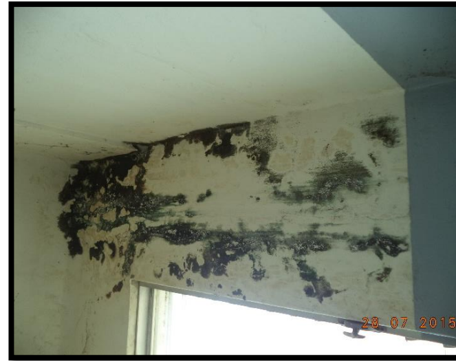
Figura 93: Humedad por filtración en la pared del tercer nivel. Recuperado de Archivos Fotográficos Propios, 2015.
