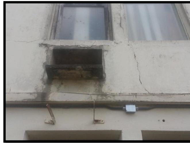
Figura 48 Churretones limpios a causa de la lluvia en la fachada este. Recuperado de Archivos Fotográficos Propios, 2015.
