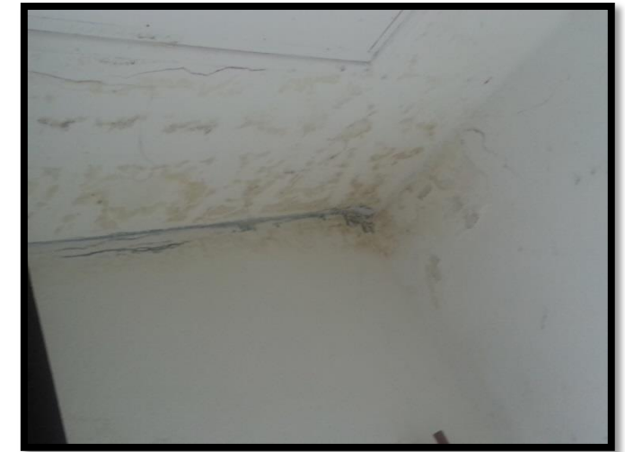
Figura 79 Humedad de filtración en losa del tercer nivel por deficiencia de la impermeabilización. Recuperado de Archivos Fotográficos Propios, 2015.
