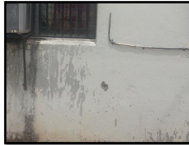
Figura 56 Erosión en paredes de la fachada norte. Recuperado de Archivos Fotográficos Propios, 2015.
