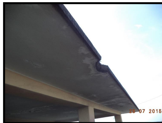
Figura 70 Desprendimiento en losa de caseta de ascensor por causa de instalación de estructura para el tanque de agua. Recuperado de Archivos Fotográficos Propios, 2015.
