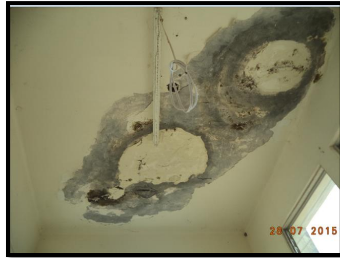
Figura 92: Humedad de filtración por deficiencia de la impermeabilización en losa del tercer nivel. Recuperado de Archivos Fotográficos Propios, 2015.
