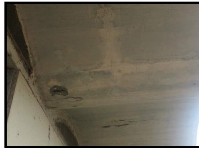
Figura 82 Erosión por humedad de filtración Recuperado de Archivos Fotográficos Propios, 2015.
