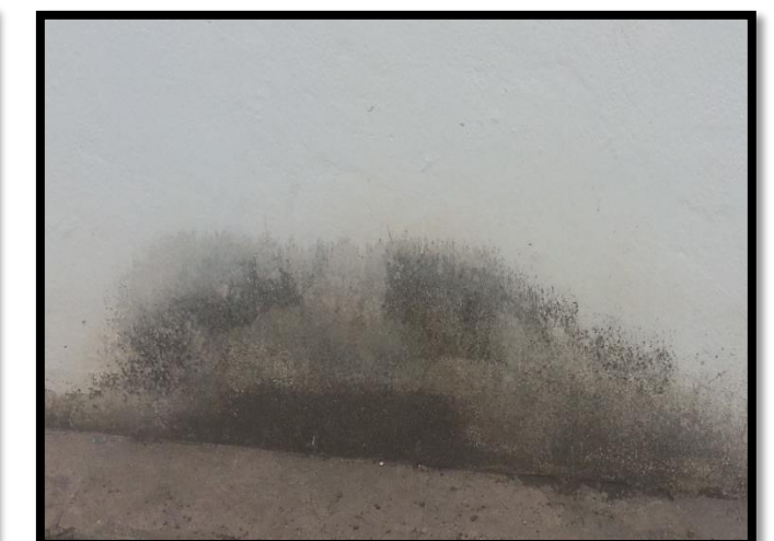
Figura 47 Erosión de la pintura a causa de agentes atmosféricos en fachada norte. Recuperado de Archivos Fotográficos Propios, 2015.
