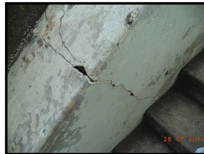
Figura 34 Grietas en pasamanos de escaleras a causa de acciones mecánicas externas. Recuperado de Archivos Fotográficos Propios, 2015.
