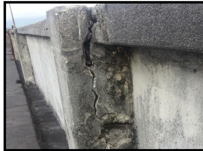
Figura 50 Grieta por expansión del acero. Recuperado de Archivos Fotográficos Propios, 2015.
