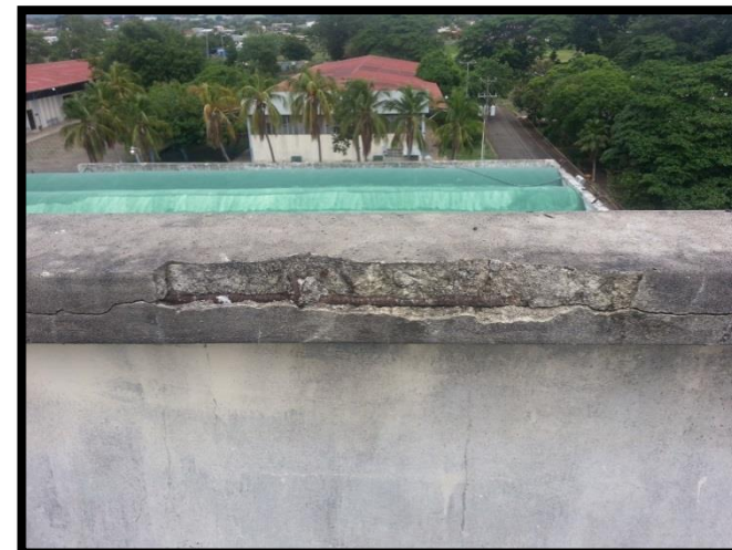
Figura 58 Oxidación en armadura de viga por exposición a la intemperie fachada este. Recuperado de Archivos Fotográficos Propios, 2015.
