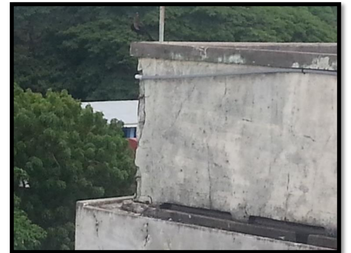
Figura 54 Desprendimiento en cerramiento a causa de una grieta producida por asiento puntual en la fachada sur. Recuperado de Archivos Fotográficos Propios, 2015.
