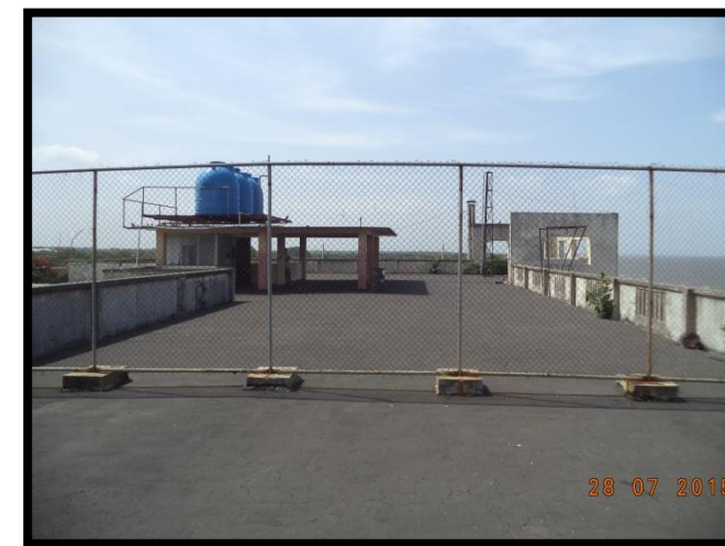
Figura 62 Alteración conceptual por instalación de malla ciclón en azotea. Recuperado de Archivos Fotográficos Propios, 2015.
