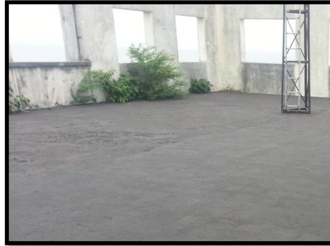
Figura 75 Proliferación de vegetales a causa de la humedad y falta de mantenimiento en azotea. Recuperado de Archivos Fotográficos Propios, 2015.
