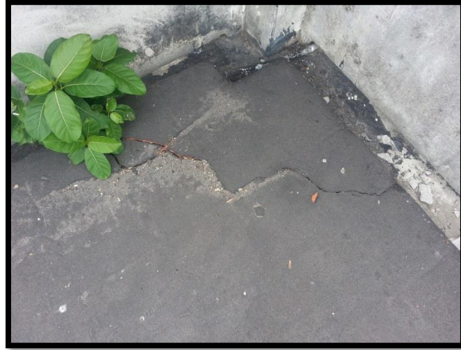
Figura 76 Proliferación de vegetales a causa de la humedad y falta de mantenimiento en azotea. Recuperado de Archivos Fotográficos Propios, 2015.
