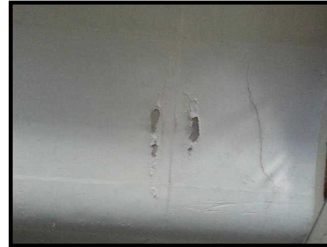
Figura 73 Fisuras a causa de empujes laterales en la placa ondulada interior. Recuperado de Archivos Fotográficos Propios, 2015.
