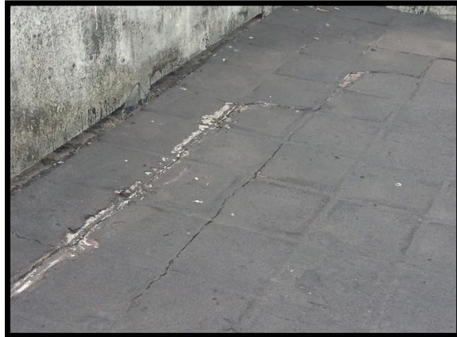
Figura 69 Erosión de juntas en Azotea Recuperado de Archivos Fotográficos Propios, 2015.B
