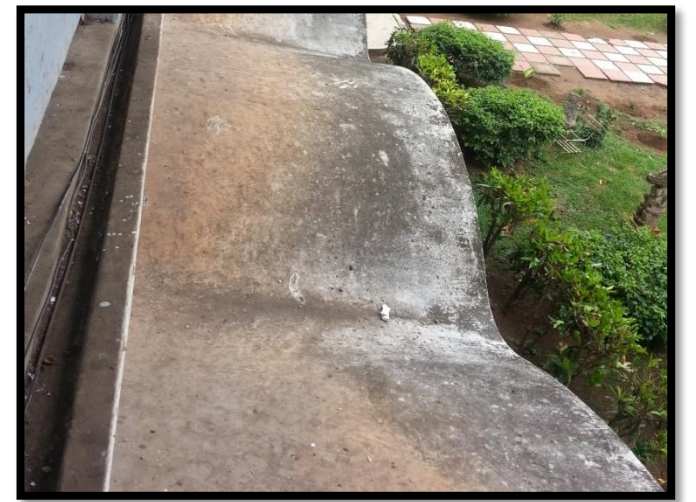
Figura 81 Erosión a causa de agentes atmosféricos del material primer piso Recuperado de Archivos Fotográficos Propios, 2015.
