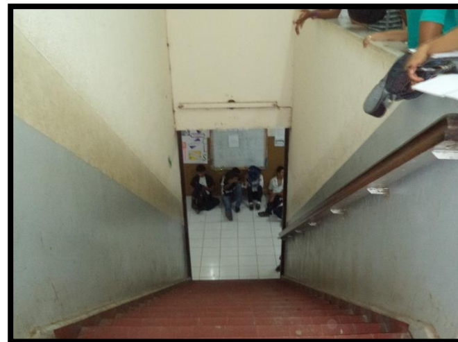
Figura 87: Suciedad en la pared por acumulación de grasa y polvo de las escaleras del segundo nivel. Recuperado de Archivos Fotográficos Propios, 2015.
