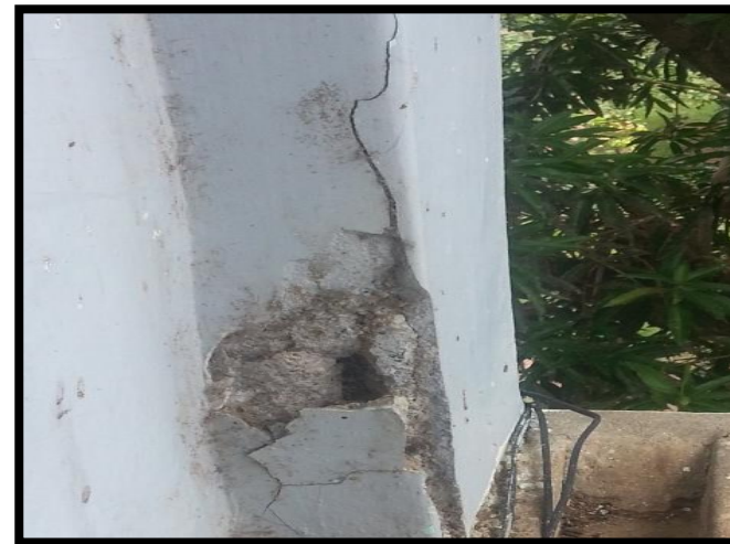
Figura 51 Grieta en columna en la fachada este. Recuperado de Archivos Fotográficos Propios, 2015.
