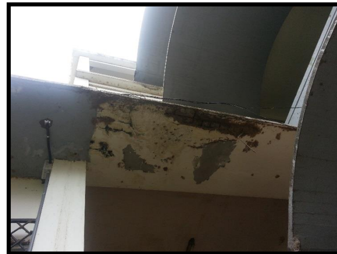
Figura 111: Oxidación en varillas de acero en losa de entrepiso por exposición a la intemperie. Recuperado de Archivos Fotográficos Propios, 2015.
