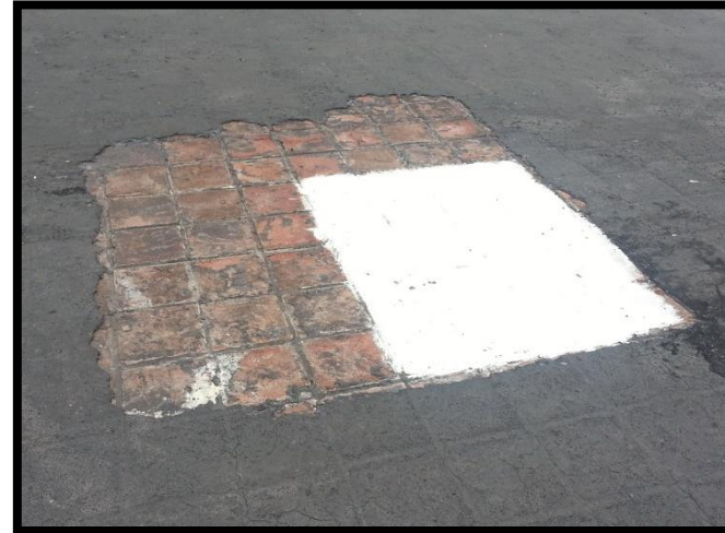
Figura 68 Erosión a causa de pruebas de impermeabilizantes no concluidas en azotea Recuperado de Archivos Fotográficos Propios, 2015.
