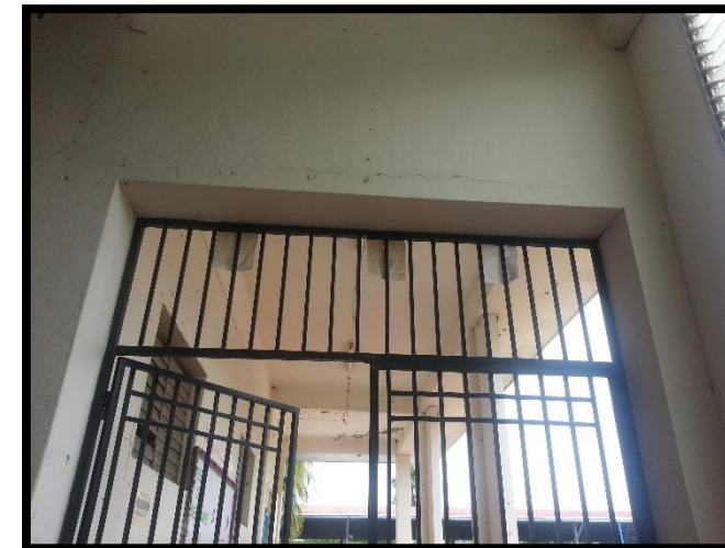
Figura 99: Fisura por empujes verticales en la parte superior del vano de la puerta en el primer nivel. Recuperado de Archivos Fotográficos Propios, 2015.
