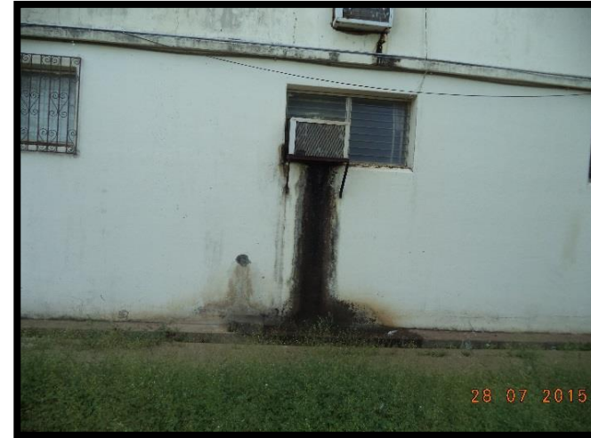
Figura 41 Humedad accidental a causa de falta de tuberías para la conducción del agua del aire acondicionado en la fachada oeste. Recuperado de Archivos Fotográficos Propios, 2015.
