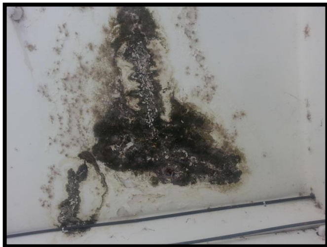
Figura 77 Humedad de filtración en losa por deficiencia de la impermeabilización. Recuperado de Archivos Fotográficos Propios, 2015.
