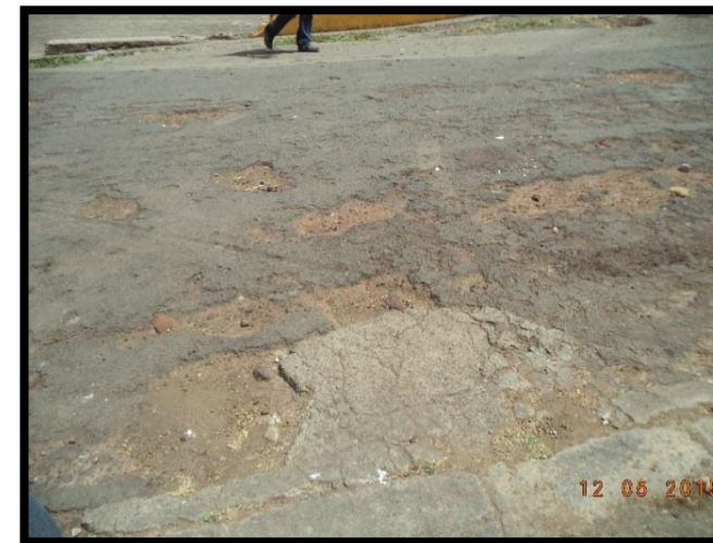
Figura 38 Erosión de asfalto en calle principal a causa de abrasión. Recuperado de Archivos Fotográficos Propios, 2015.
