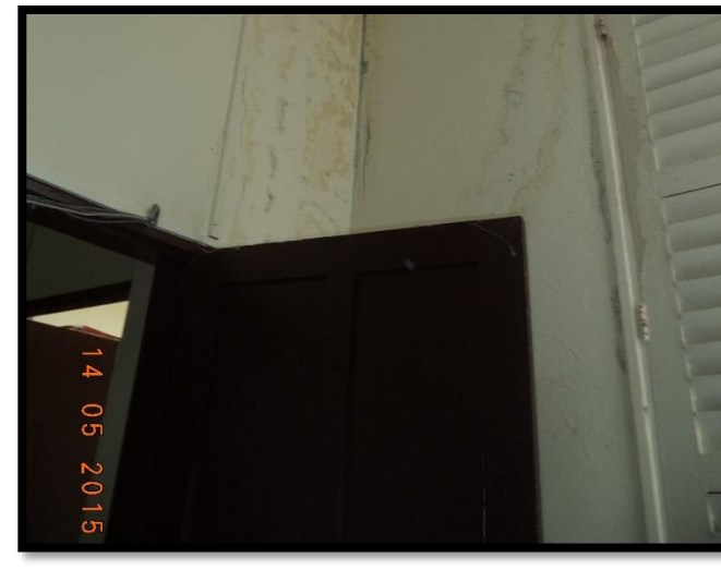
Figura 91. Desprendimiento de la pintura por humedad de filtración en bienestar estudiantil del segundo nivel. Recuperado de Archivos Fotográficos Propios, 2015.
