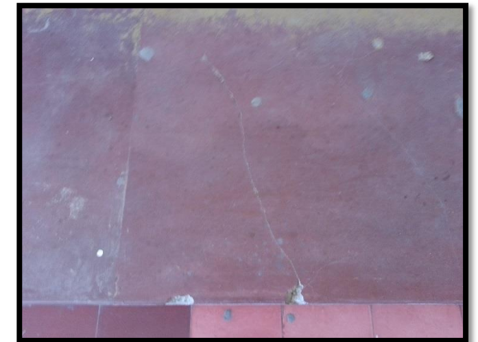
Figura 98: fisura en el piso por esfuerzos rasantes en el pasillo del segundo nivel. Recuperado de Archivos Fotográficos Propios, 2015.
