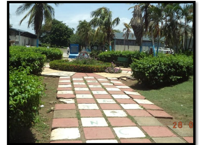
Figura 35 Desprendimiento de baldosa Recuperado de Archivos Fotográficos Propios, 2015.
