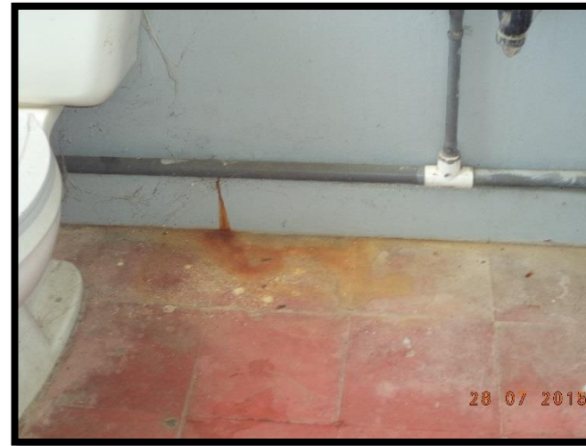
Figura 112: Manchas en el piso de los S.S del tercer nivel. Recuperado de Archivos Fotográficos Propios, 2015.
