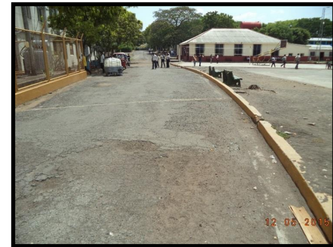
Figura 37 Pérdida total del pavimento debido a la erosión del asfalto. Recuperado de Archivos Fotográficos Propios, 2015.
