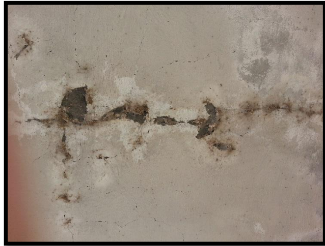
Figura 109: Eflorescencia por humedad de filtración en paredes del pasillo del segundo nivel. Recuperado de Archivos Fotográficos Propios, 2015.
