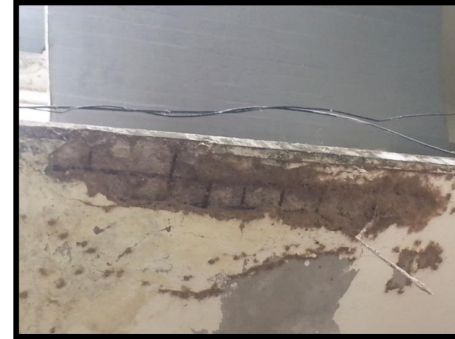
Figura 60 Corrosión de armadura en losa por exposición a la intemperie Fachada sur. Recuperado de Archivos Fotográficos Propios, 2015.
