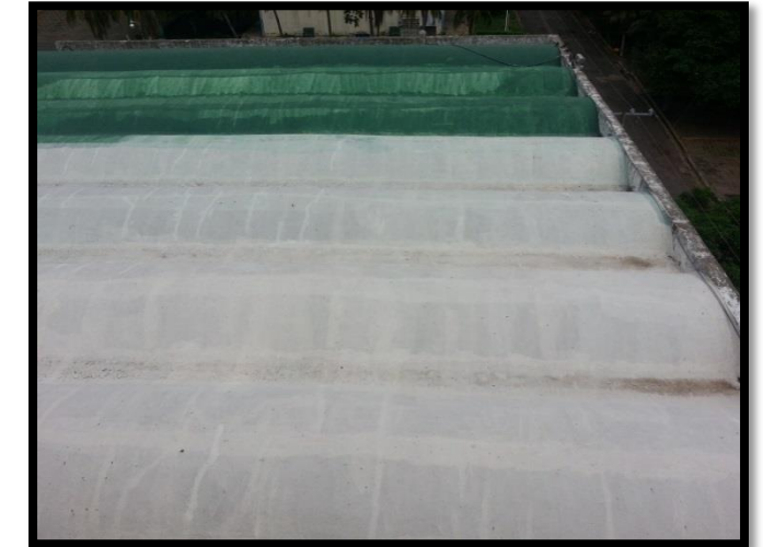
Figura 72 Fisuras a causa de empujes laterales en la placa ondulada Recuperado de Archivos Fotográficos Propios, 2015.
