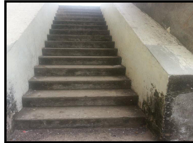
Figura 32 Humedad capilar en pasa manos de escaleras a causa de la ascensión del agua. Recuperado de Archivos Fotográficos Propios, 2015.
