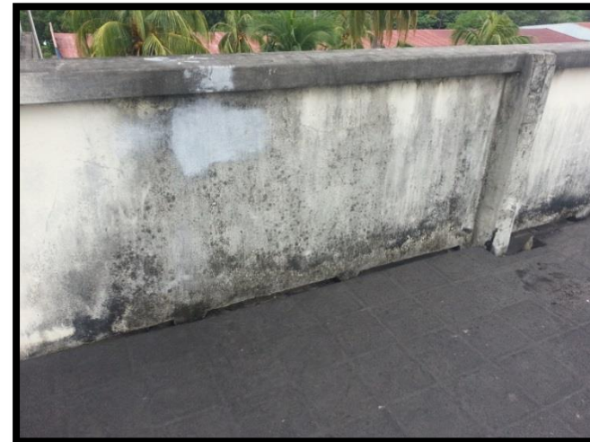
Figura 45 Humedad de absorción producido por el agua de lluvia a través del poro del material en la azotea. Recuperado de Archivos Fotográficos Propios, 2015.
