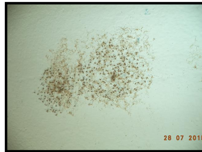
Figura 115: Nido de insectos en paredes del tercer nivel. Recuperado de Archivos Fotográficos Propios, 2015.
