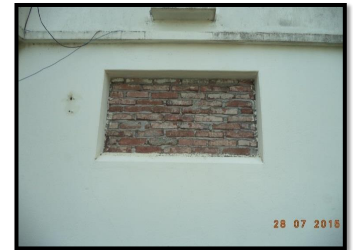
Figura 63 Alteración conceptual por el sellado de ventana fachada oeste. Recuperado de Archivos Fotográficos Propios, 2015.
