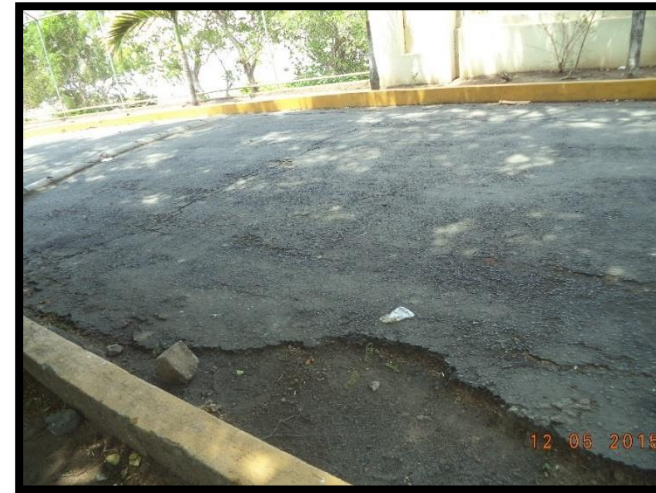
Figura 36 Desprendimiento de asfalto en calle principal a causa de esfuerzos rasantes. Recuperado de Archivos Fotográficos Propios, 2015.
