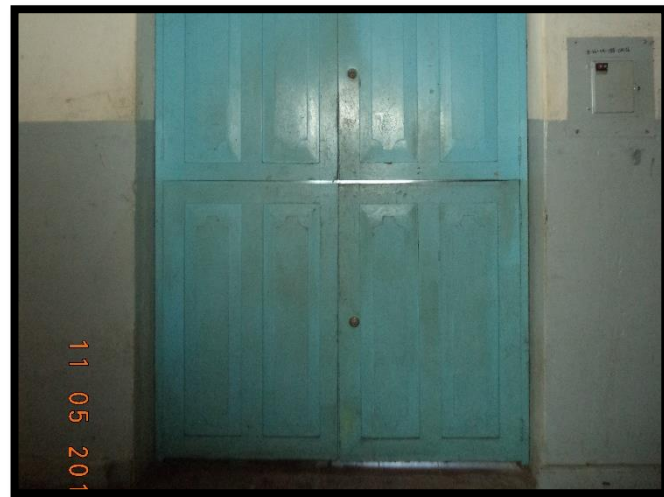
Figura 86: Suciedad por acumulación de grasa y polvo en la puerta de bodega del segundo nivel. Recuperado de Archivos Fotográficos Propios, 2015.
