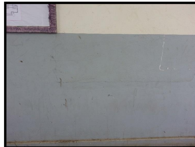
Figura 95: Fisura por flexión debido a acciones verticales en el pasillo del primer nivel. Recuperado de Archivos Fotográficos Propios, 2015.
