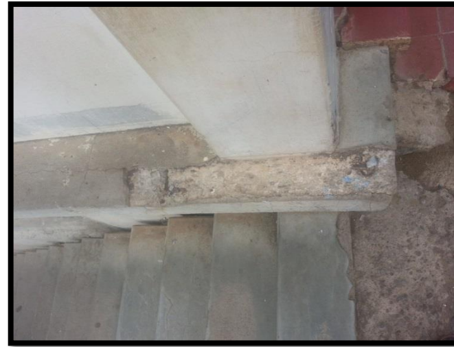
Figura 57 Erosión por roce permanente de sujetos en la Fachada este. Recuperado de Archivos Fotográficos Propios, 2015.
