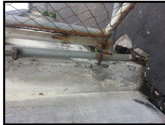
Figura 108: Oxidación por exposición a la intemperie en porton de la azotea. Recuperado de Archivos Fotográficos Propios, 2015.
