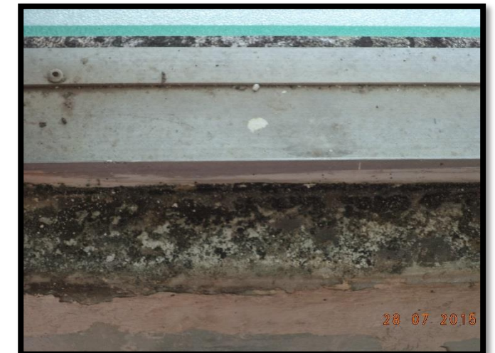
Figura 114: Moho por humedad accidental en la parte inferior de las ventanas en el tercer nivel. Recuperado de Archivos Fotográficos Propios, 2015.
