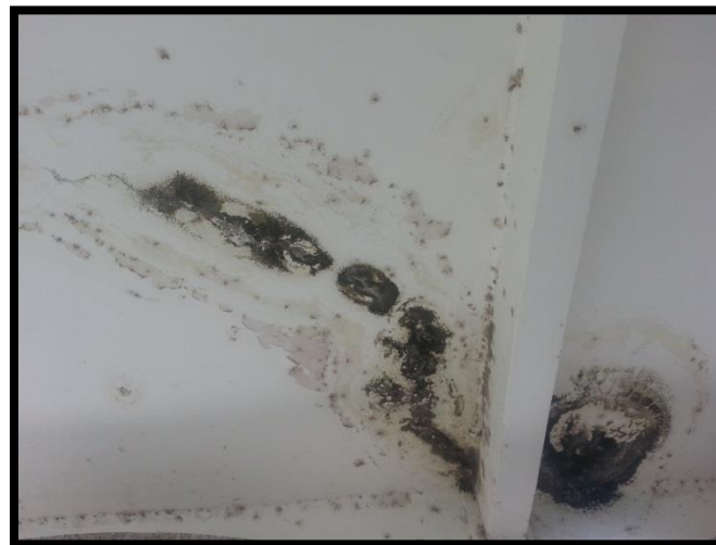
Figura 78 Humedad de filtración en losa por deficiencia de la impermeabilización. Recuperado de Archivos Fotográficos Propios, 2015.
