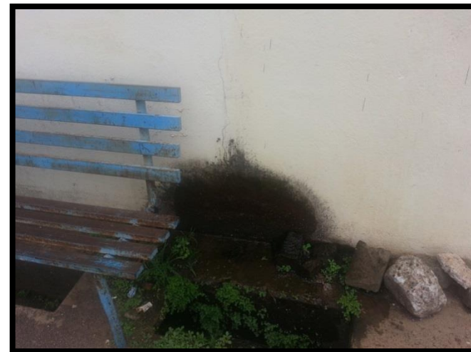
Figura 43 Humedad accidental a causa de tuberías rotas en la fachada oeste. Recuperado de Archivos Fotográficos Propios, 2015.
