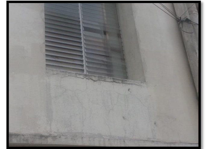
Figura 53 Fisuras por empujes verticales en segundo piso fachada norte. Recuperado de Archivos Fotográficos Propios, 2015.
