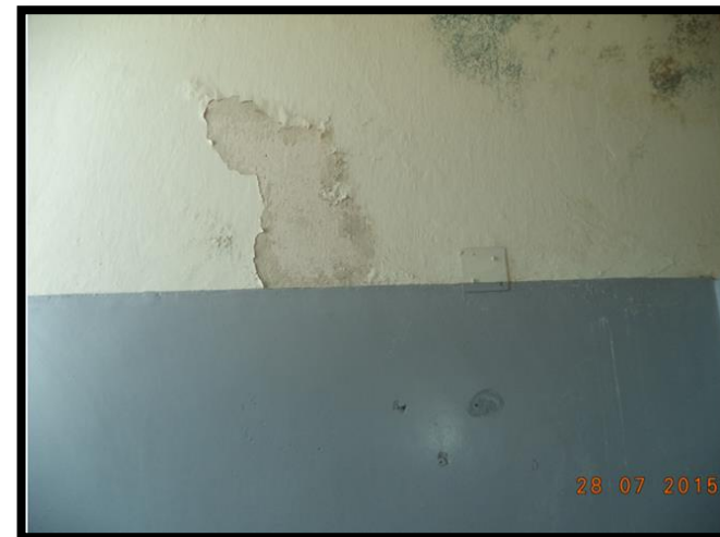
Figura 90: Desprendimiento de la pintura por falta de adherencia entre la pintura y el soporte en el pasillo del primer nivel. Recuperado de Archivos Fotográficos Propios, 2015.
