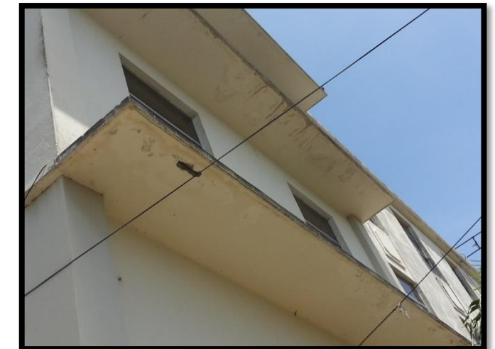
Figura 44 Humedad de absorción producido por el agua de lluvia a través del poro del material en la fachada oeste. Recuperado de Archivos Fotográficos Propios, 2015.
