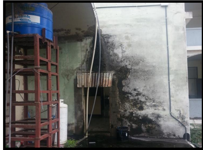
Figura 40 Humedad accidental producida a causa de tuberías rotas fachada este. Recuperado de Archivos Fotográficos Propios, 2015.
