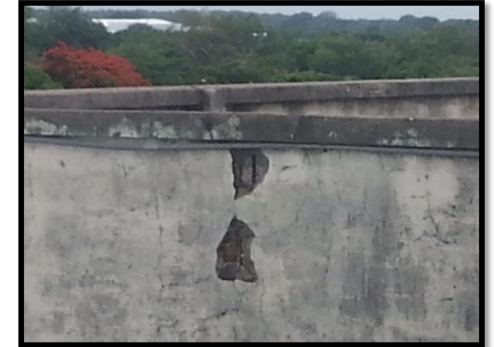
Figura 61 Corrosión de armadura en cerramiento de por exposición a la intemperie Fachada sur. Recuperado de Archivos Fotográficos Propios, 2015.
