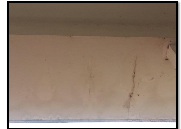
Figura 97: Grieta en marquesina del pasillo del primer nivel. Recuperado de Archivos Fotográficos Propios, 2015.
