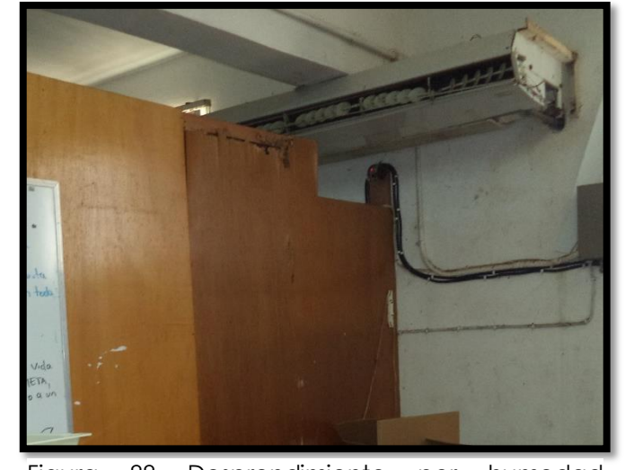
Figura 88 Desprendimiento por humedad accidental en lamina de plywood oficina de planta baja. Recuperado de Archivos Fotográficos Propios, 2015.
