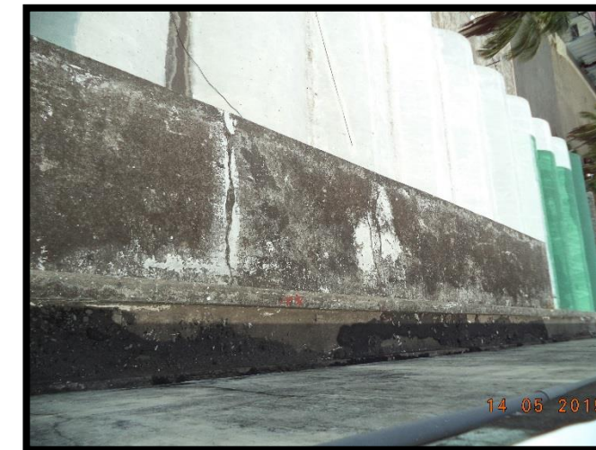
Figura 74 Fisuras en marquesina. Recuperado de Archivos Fotográficos Propios, 2015.
