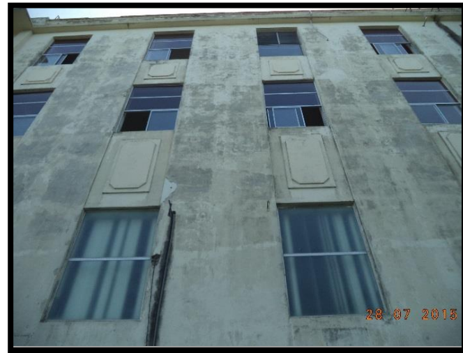
Figura 49 Lavado diferencial en la Fachada este. Recuperado de Archivos Fotográficos Propios, 2015.
