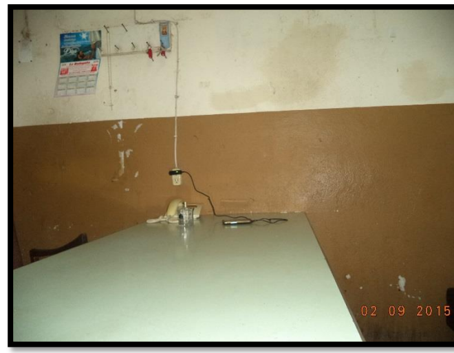
Figura 85 Suciedad en la pared por acumulación de grasa y polvo. Recuperado de Archivos Fotográficos Propios, 2015.
