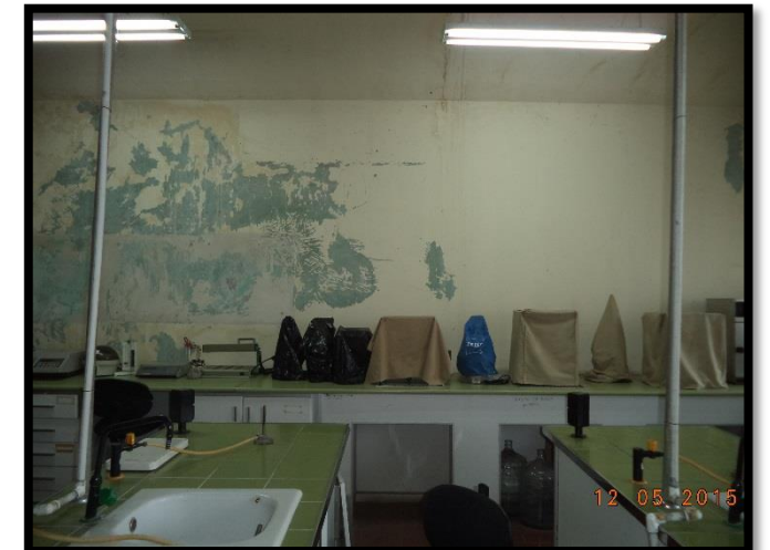
Figura 89: Desprendimiento de la pintura por humedad de filtración en el laboratorio del segundo nivel. Recuperado de Archivos Fotográficos Propios, 2015.
