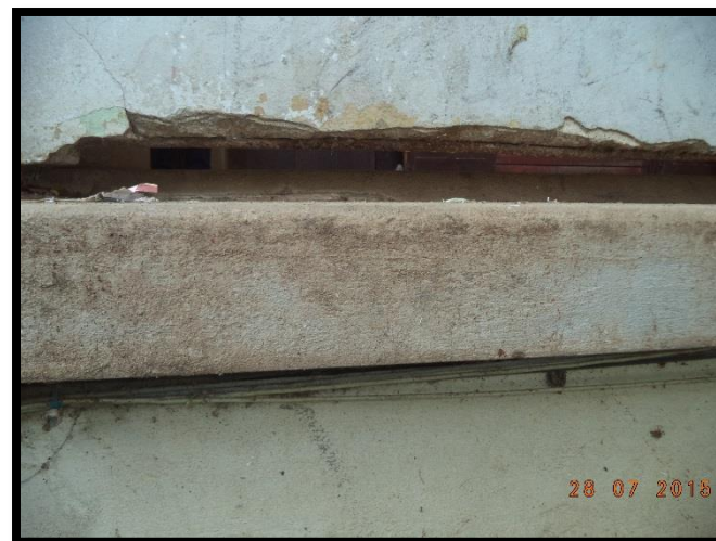
Figura 110: Oxidación en varillas de acero por exposición a la intemperie. Recuperado de Archivos Fotográficos Propios, 2015.
