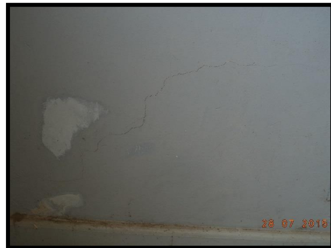
Figura 94: Fisura por asiento continuo en el pasillo del primer nivel. Recuperado de Archivos Fotográficos Propios, 2015.
