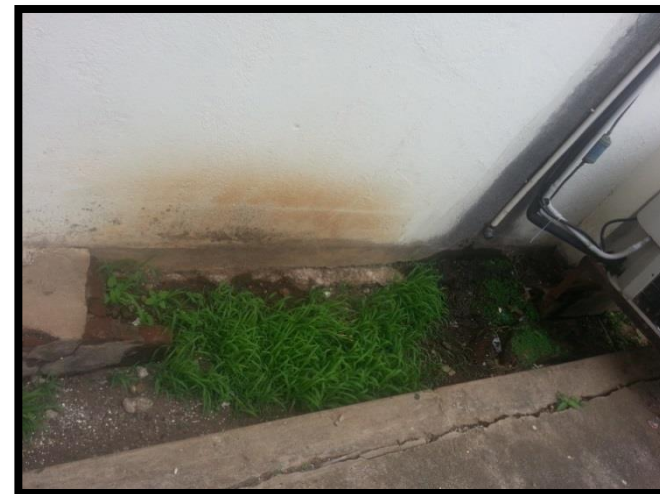
Figura 42 Humedad capilar a causa de la ascensión del agua en la fachada oeste. Recuperado de Archivos Fotográficos Propios, 2015.
