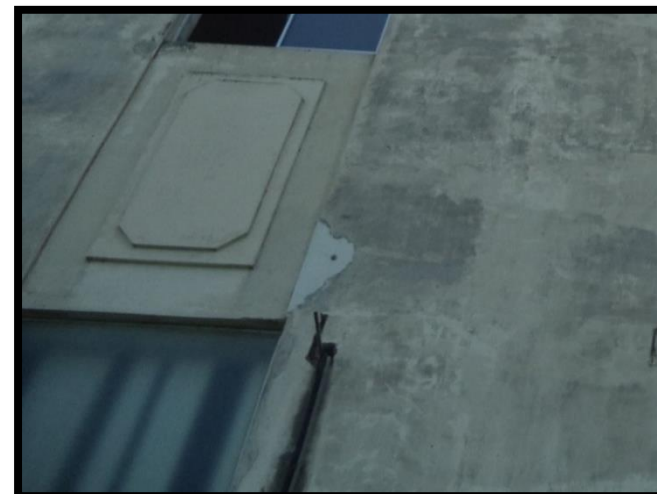
Figura 46 Erosión puntual del revoco a causa de agentes atmosféricos en la fachada este. Recuperado de Archivos Fotográficos Propios, 2015.
