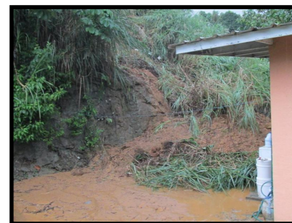
Fotografía No 30: Vivienda afectada por deslizamiento en laderas del cerro La Mokuana.
