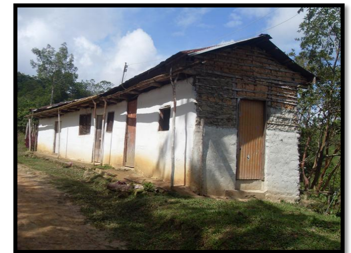
Fotografía No 29: Vivienda con paredes inadecuadas y techo en mal estado (Comunidad Chagüite Blanco)
