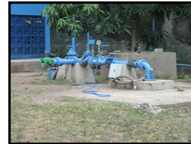
Fotografía No 16: Sistema de Bombeo de Agua Potable en el Municipio.
