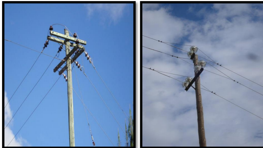
Fotografía No 20: Postes de Tendido Eléctrico de Concreto y Madera de pino. En el Casco Urbano
