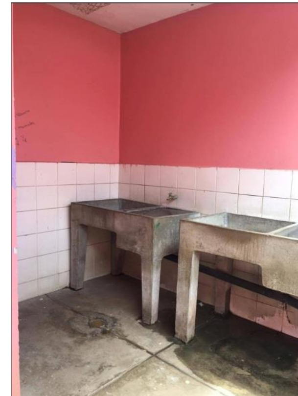
Ilustración 30 Área de lavandería
