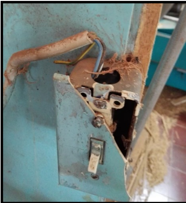
Ilustración 13. Instalaciones eléctricas de máquinas en mal estado
