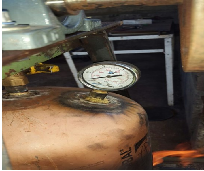
Figura N° 21 (medidor de presión, "presostato")
