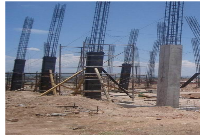
ILUSTRACIÓN 40, ESTRUCTURA DE SISTEMA ARMADO, FUENTE ELABORADO POR LOS AUTORES
