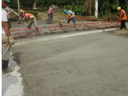
Figura 5. Equipo de formaleta fija: regla vibratoria autopropulsada.
