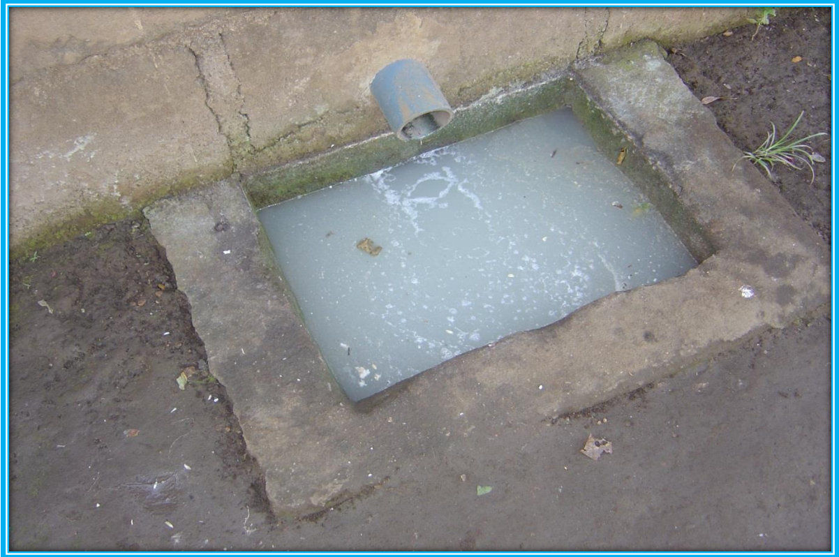
Pila de aguas grises
