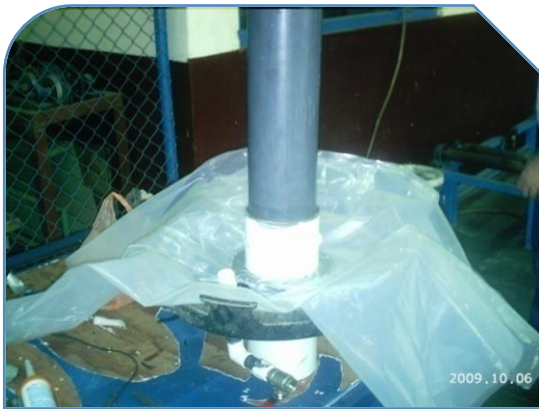
Ilustración 8: Sellado de Tuberías
