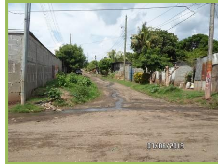
Imagen 19 Calle del Bo. Tangara deteriora por aguas grises
