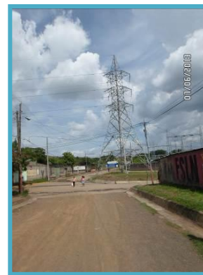
Imagen 2 Torre de alta tensión
