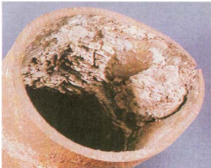
Fig. 3.2 Depósito rico en hidróxido de sodio sobre el lado del hogar de un tubo de pared de una caldera. Obsérvese la comba debida al Sobrecalentamiento de larga duración.
