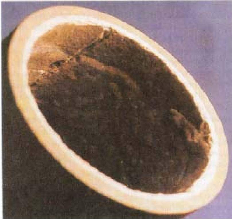
Fig. 3.3 Deposito formado por carbonatos de calcio
