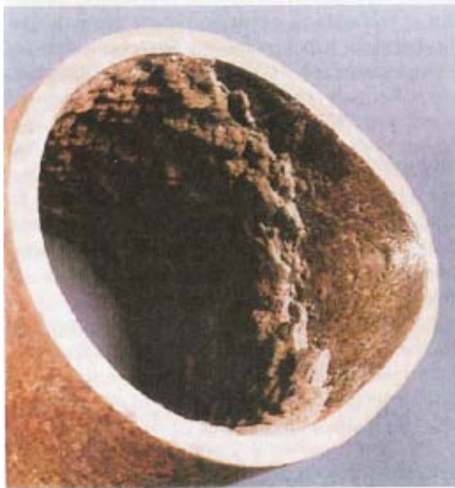
Fig. 3.4 Analcita formada por el arrastre de alumbre desde los clarificadores. Obsérvese cómo se han desprendido costras del depósito de la comba.
