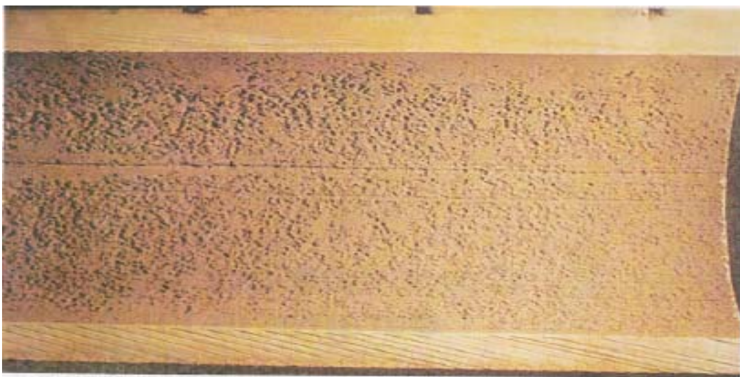
Fig. 3.8 Corrosión ácida sobre la superficie interna de un tubo de pared.
