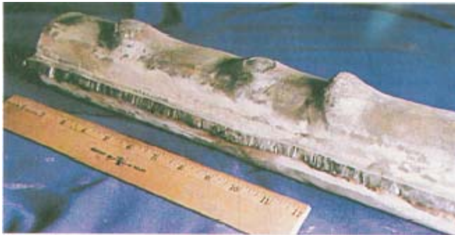
Fig. 3.10 Combas múltiples y bruscas sobre la cara caliente de un tubo de la pantalla de agua de una caldera de recuperación.
