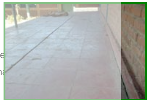
Vista del pasillo del agrupamiento 2 se puede observar el desnivel del piso
