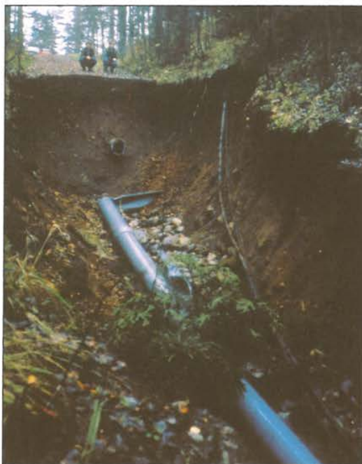
Kuva 7.24. Vesilaitoksen historian todennäköisesti pahin vuoto sattui Ahveniston harjun sairaalan linjassa 14.10.1988. Samana päivänä vesilaitoksen pitkäaikainen verkototeknikko Veikko Hietalahti jäi eläkkeelle. Vesiryöppy siirsi maa-ainesta ennennäkemättömällä tavalla satoja kuutioita. (VL)
