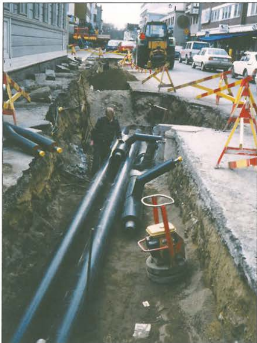
Kuva 7.14. Vedenjakelun varmistamiseksi vesilaitos joutuu välillä avaamaan katuja myös kaupungin keskustassa. Kuvassa vesilaitoksen putkityömaa Hallituskadulla kesällä 1990. (VL)
