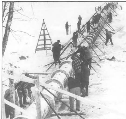
Kuva 9.4. Imujohdon laskua Katuman pumppuasemalla helmikuussa 1955. Imu- johto tehtiin lankuista, jotka sidottiin teräs- vantein ja varustettiin betonipainoilla. (VL)
