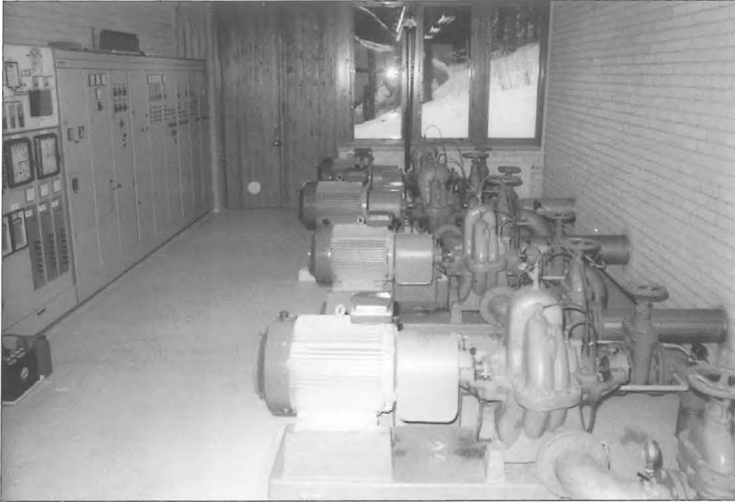
Kuva 8.12. Kylmälahden pohjavedenottamon pumppuhuone vuonna 1999. Pumput on peruskorjattu vuonna 1984. (VL)
