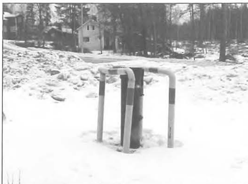
Kuva 12.9. Vesijohtoverkon ulkopuolelle jäi Hämeenlinnassa vuonna 1999 vielä vähäisiä haja-asutusalueita. Kuvassa on vuonna 1999 ainoa käytössä ollut yleinen vesiposti Luolajassa. (Manninen)
