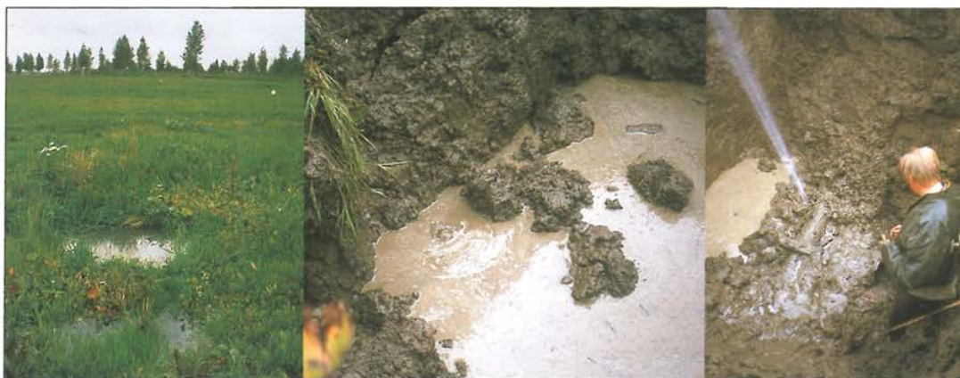
Kuva 7.23. Hämeen Puhelimen ja Meijerin välisessä vesijohdossa maan päälle ilmestyneen lammikon takia havaittu vuoto 1978. Reino Puro onnistui puutapilla tukkimaan vesisuihkun. (VL)
