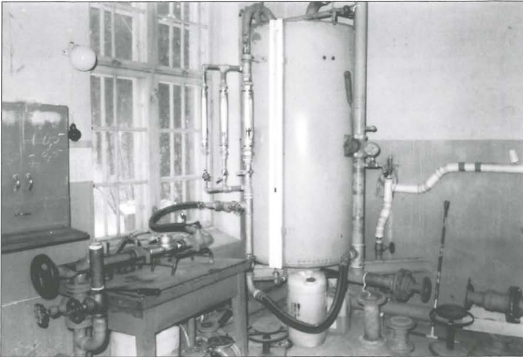
Kuva 7.18. Vesilaitoksen mittarinkorjaamo Ahveniston vanhalla vesilaitoksella. Vuonna 1982 mittarikorjaamo muutti kaupungin uuden korjaamo-keskusvaraston tiloihin Suosaarentielle. (VL)
