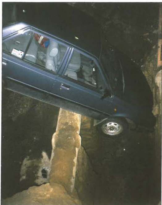
Kuva 7.22. Auto sadevesiputken päällä Poltinahontien kaivannossa 1989. Liian kovaa vauhtia jäisellä tiellä ajanut auto syöksyi viemärytömaamonttuun, jossa Raimo Levänen tapahtumahetkellä työskenteli. Tämän jälkeen kaivannoista maa-aines on nostettu aina tulevan liikenteen suuntaan. (VL)
