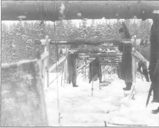
Kuva 9.5. Imujohdon lasku Katuman pumppuasemalla 18.2.1955. (VL)
