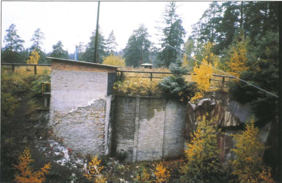
Kuva 7.11. Kuvassa vuonna 1954 rakennettu Sairion vesisäiliö ennen viereisen montun täyttöö. Suunnitelmassa oli toisen samanlaisen vesisäiliön rakentaminen ensimmäisen säiliön viereen. Säiliötä ei kuitenkaan rakennettu, ja monttu täytettiin vuonna 1985. (VL)
