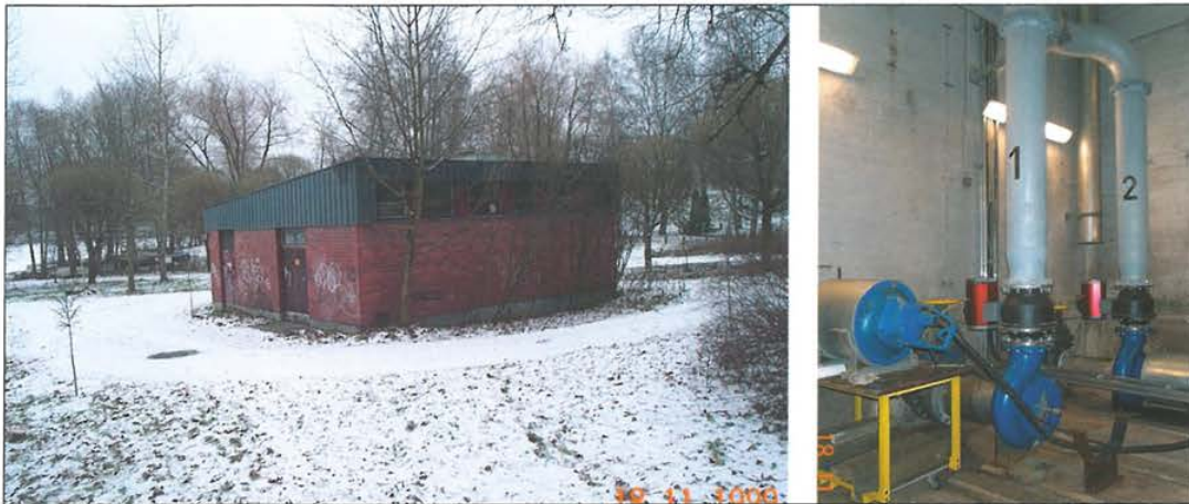
Kuva 7.13. Hämeenlinnassa on maasto-olojen vuoksi tarvittu suhteellisen paljon jätevedenpumppaamoja. Vuonna 1999 niitä oli käytössä 101 kappaletta. Kuvassa on kaupunginpuistoon vuonna 1966 rakennettu jäteveden pääpumppaamo. (JVL)
