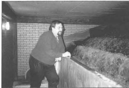
Kuva 8.19. Päivystäjä Matti Nylund Ahveniston uuden vesilaitoksen ilmastushuoneessa. (VL)
