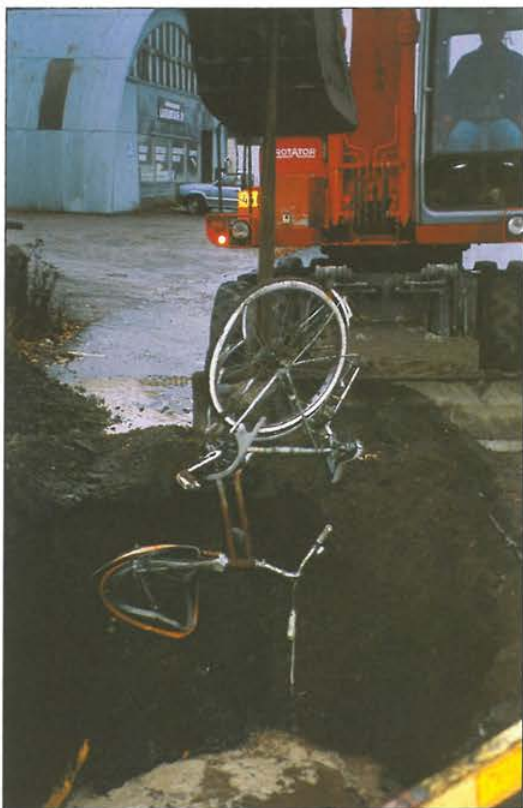
Kuva 7.21. Kuva Eino Leinin kadun vuoto-työmaalta. Korjauksen jälkeen tapahtui uusi vuoto, jolloin vesi täytti avoinna olleen montun. Kaivanto näkyi maan pinnalle tavallisen vesilammikkona, johon epäonninen pyöräilijä ajoi. (VL)
