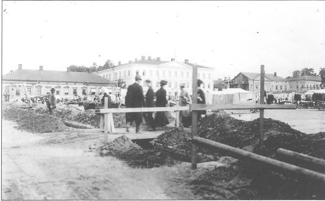
Kuva 5.3. Vuonna 1910 otetussa kuvassa työt ovat edenneet silloiselle Itäiselle Linnankadulle (myöh. Sibeliuksenkatu). Etualalla asennusta odottamassa ohuempi 125 mm vesijohdotputki ja paksumpi 150 mm paineviemäri. Putket olivat Mannesmannin menetelmällä valssattuja teräsputkia. (HKHM)
