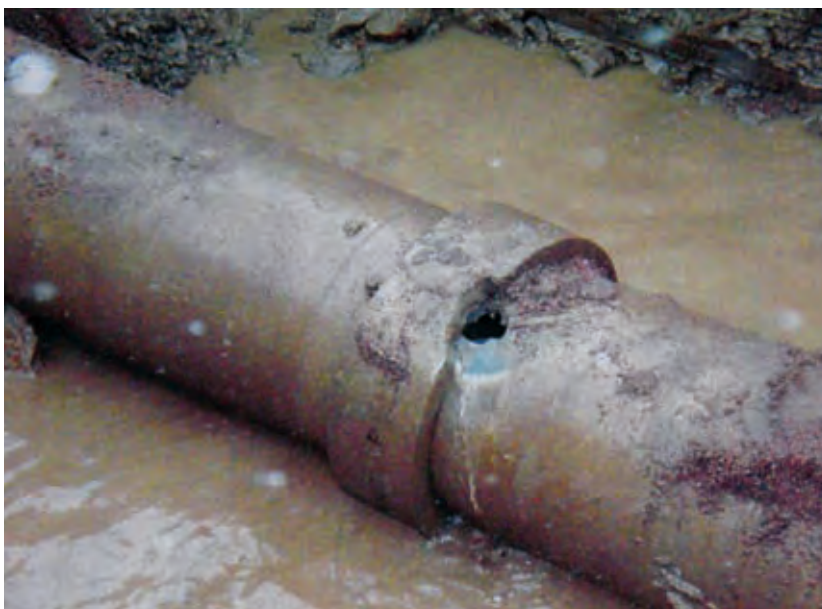
Kuva 2. Reikä asbestisementtiputkessa. (Riihimäen Vesi, varaston seinällä oleva kuva)
