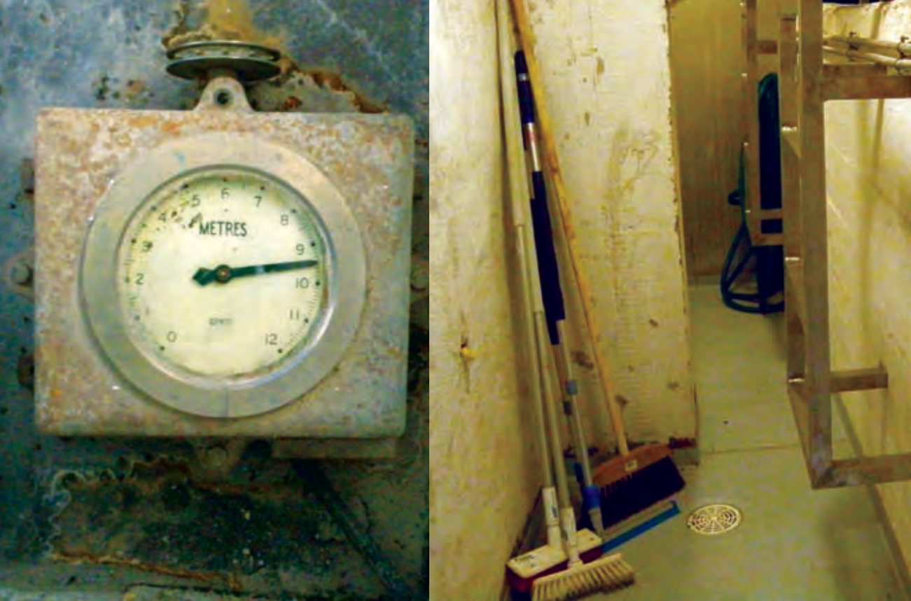
Kuva 8a ja b. Vanha mittari Vesilinnan käytävässä ja huoltotiloja. (Juuti 2009)
