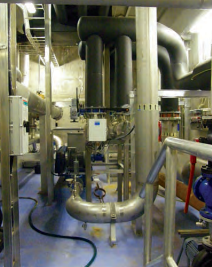
Kuva 12. Herajoen vesilaitoksen putkia. Keskellä UV-laitteisto. (Juuti 2009)
