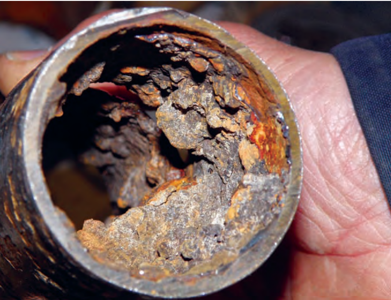
Kuva 14. Vesijohtoverkko tarvitsee huoltoa ja saneerausta. Putkinäyte johtomestarin työhuoneessa. Putken sisälle on kertynyt ylimääräistä tavaraa. (Rajala 2009)
