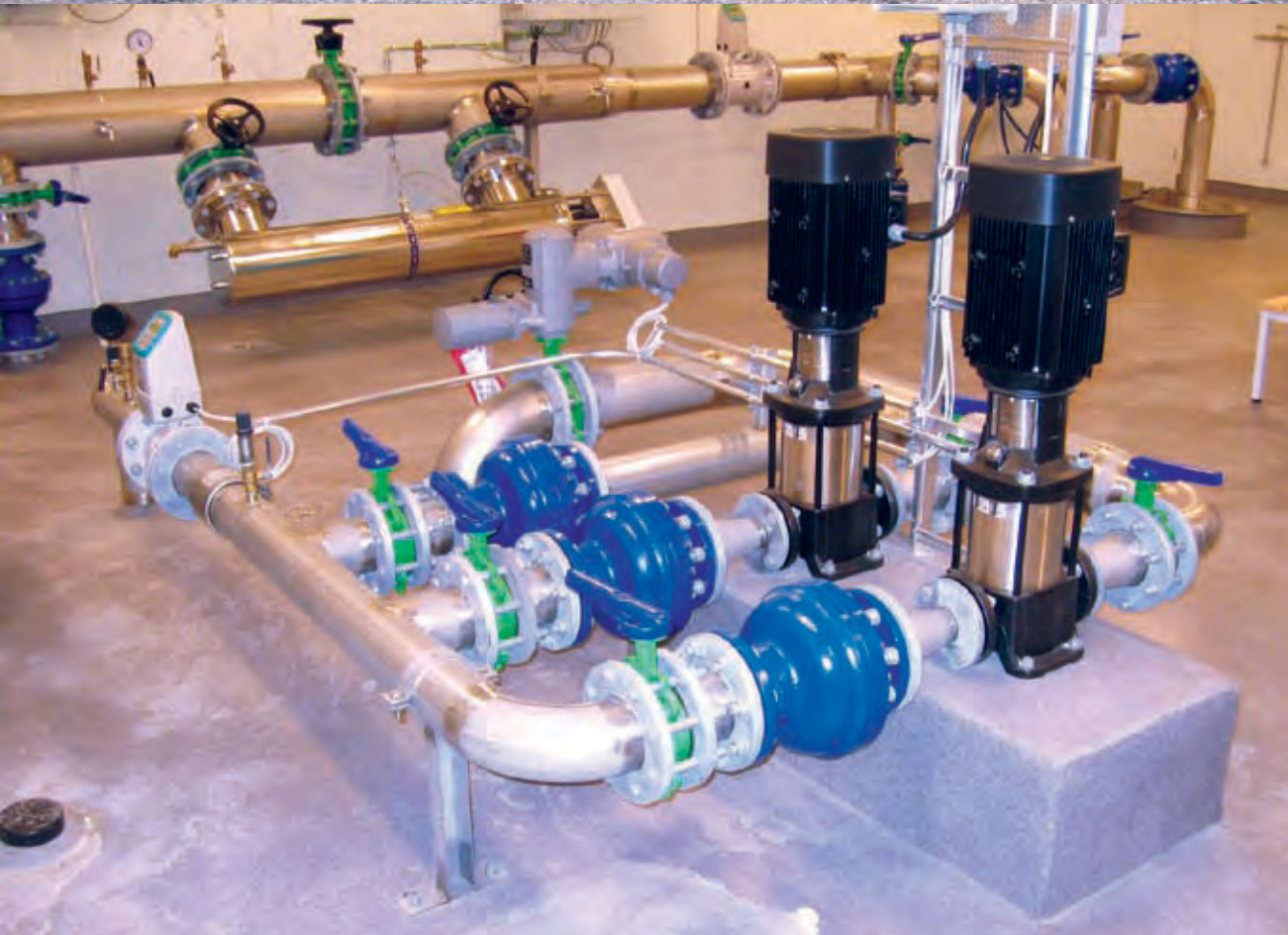
Kuva 16a ja b. Kormun vedenkäsittelylaitos otettiin käyttöön lokakuun 1. päivänä vuonna 2007. (Riihimäen Vesi 2007)
