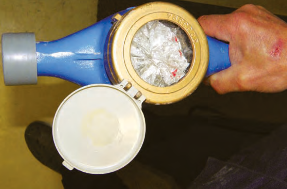
Kuva 11. Jäätynyt vesimittari. (Rajala 2009)
