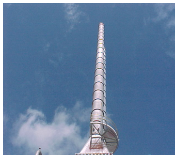
Figura 2.5: Chaminé da Fornalha.
