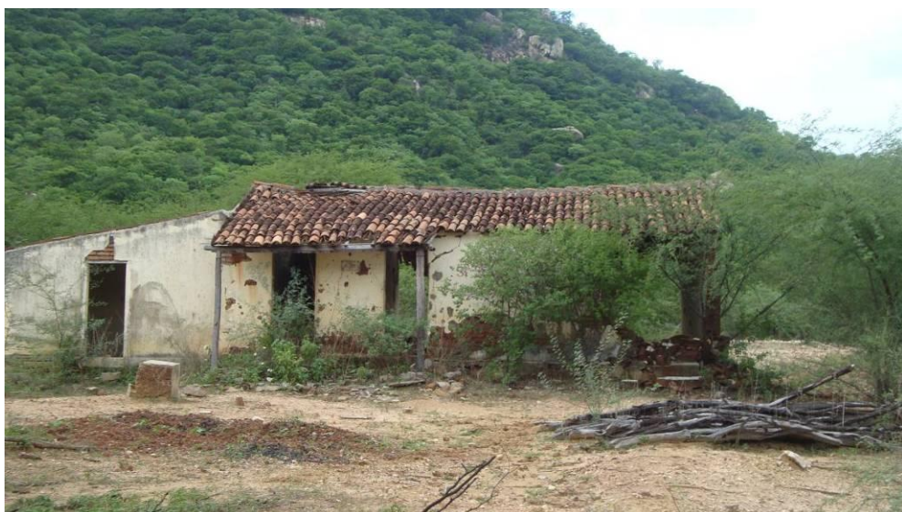
Figura 37: Casa abandonada ao longo da trilha, contextualizando a história da migração do sertanejo
