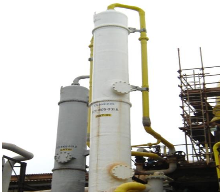
Figura 5 – Torre de stripper de água clorada de Alagoas.
